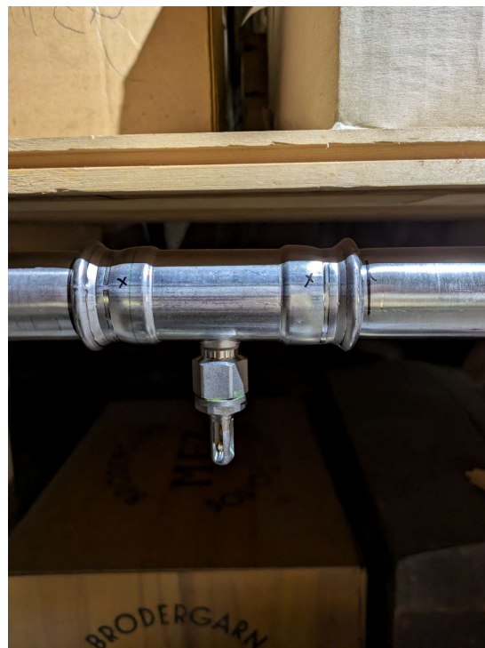
Sprinklerhode til vanntåkeanlegg.
