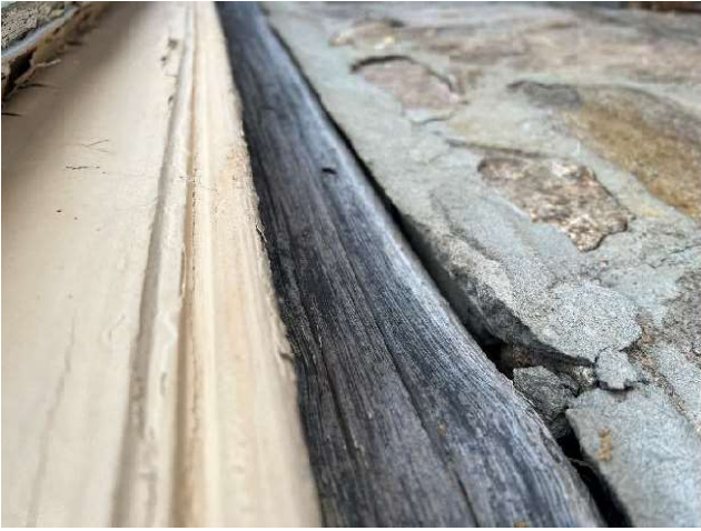
Sementfuge opp mot treverk
