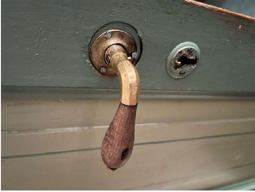
Slark og slitasje i dører og dørvridar.
