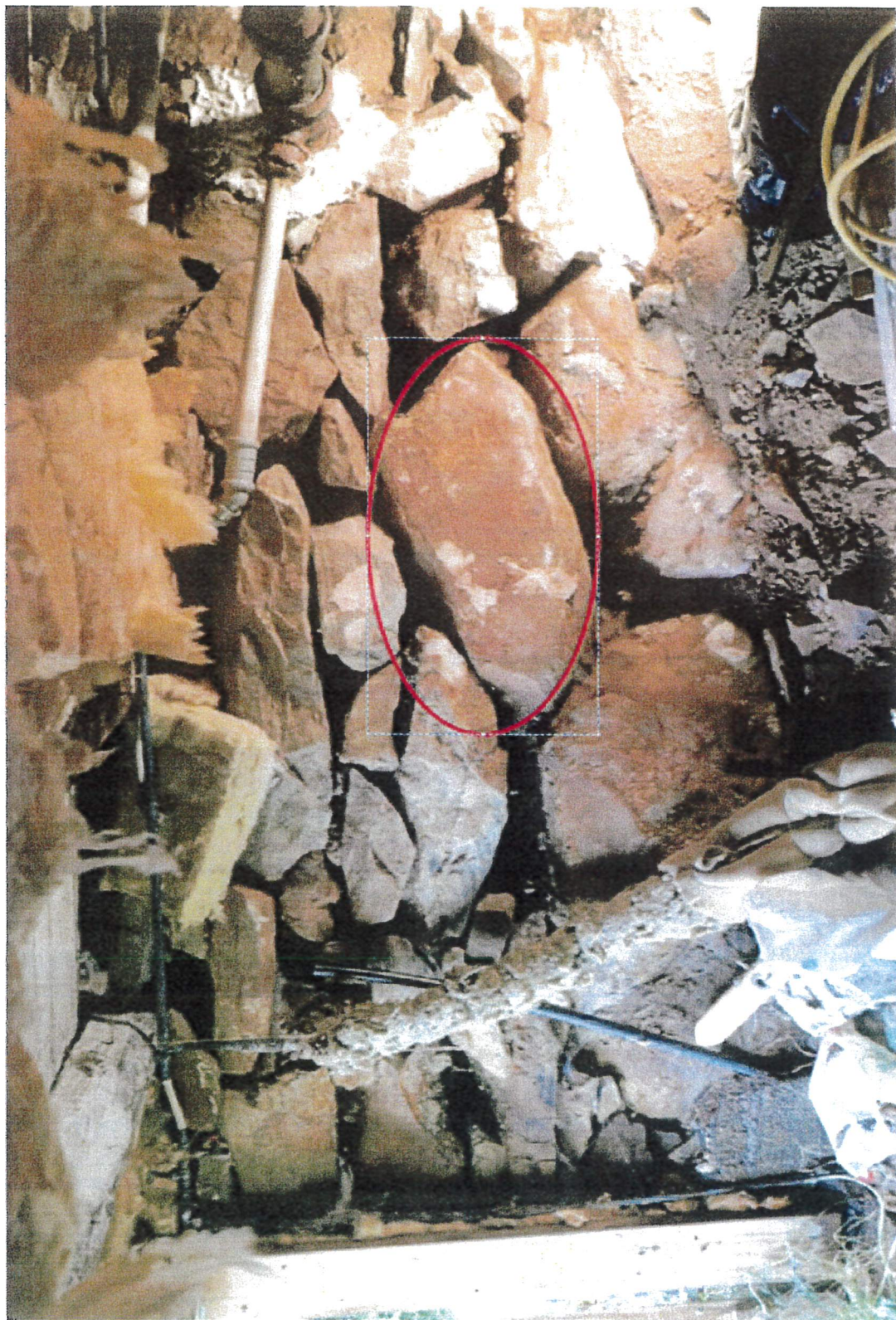
Bilde viser grunnmuren mot vest. Som man ser av bilde er mye av bindemiddelene (mørtel) mellom steinene borte. Holdsteinen som er merket med en rød ring er svært kritisk og sklir denne ut, vil store partier av denne grunnmuren også kollapse.
