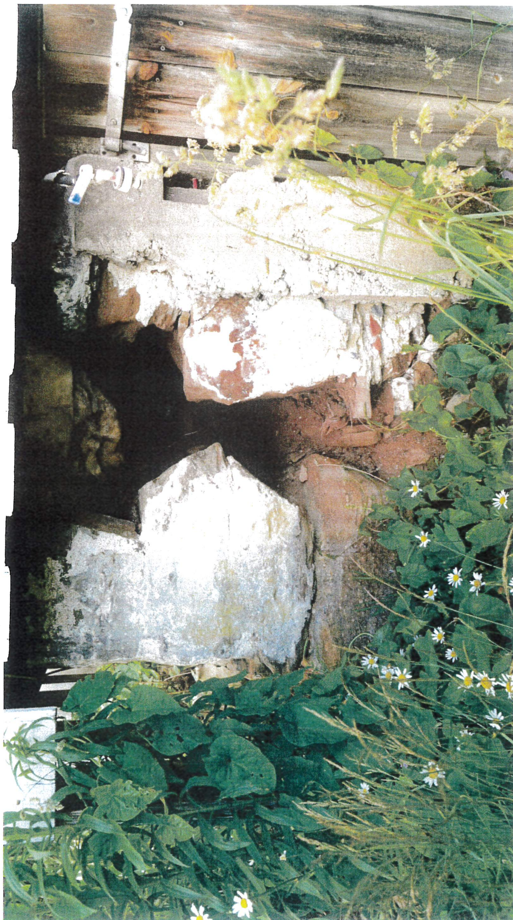
Bilde viser hjørnet av grunnmuren mot vest og sør. Som man ser er store deler av dette hjørne rast ut. Det er satt opp en provisorisk mur for å unngå at hele hjørne raser sammen og for å kunne feste dørkarmen til kjellerdøren.
