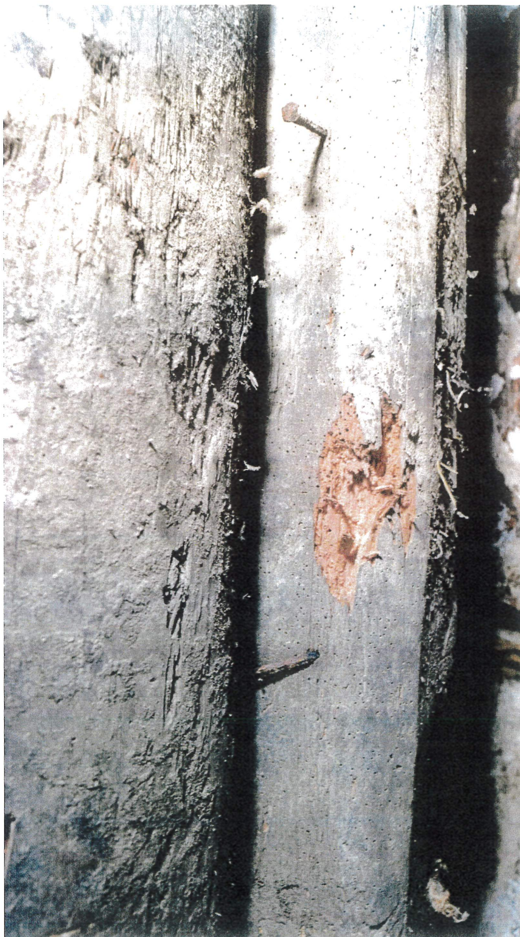
Bilde viser en bærebjelke som er kraftig angrepet stokkmaur, noe som har redusert styrken i bærebjlekene. I tillegg er disse bærebjlekene også kraftig underdimensjonert, i tillegg til at avstanden mellom disse er altfor lang i forhold til dimensjonene på bærebjlekene..
