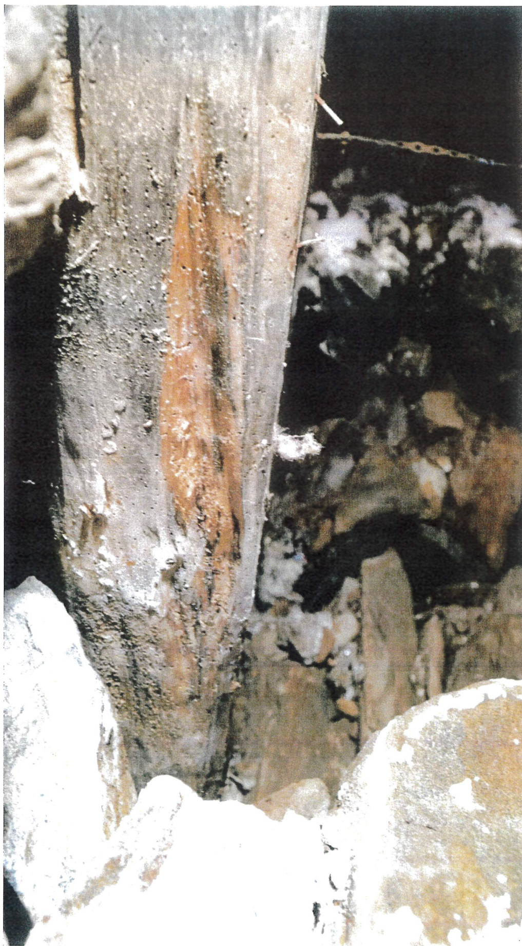
Bilde viser en bærebjelke som er kraftig angrepet stokkaure, noe som har redusert styrken i bærebjlekene. I tillegg er disse bærebjlekene også kraftig underdimensjonert, i tillegg til at avstanden mellom disse er altfor lang i forhold til dimensjonene på bærebjlekene
