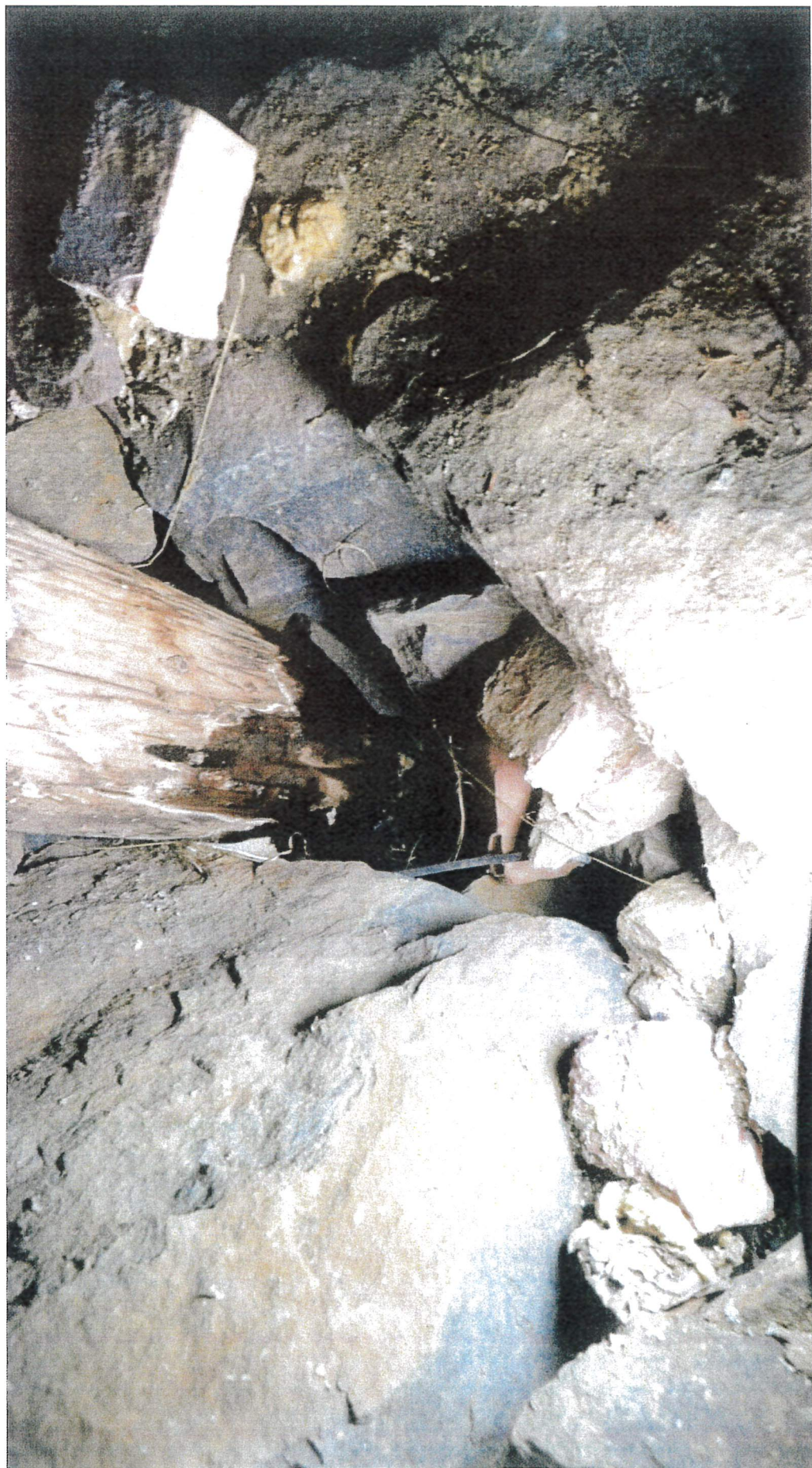
Bilde viser den ene av de to gamle telefonstolpene som bærer mesteparten av den opprinnelige boligen. Disse har stått konstant i vann i mer enn 30 år noe som har resultert i at store deler av stolpen er svært svekket og hvor det bare er et tidsspørsmål før en av disse eller begge bryter sammen og hele den opprinnelige boligen kollapse. På bilde ses tydelig fuktmerker 50 – 60 cm opp på stolpen.
