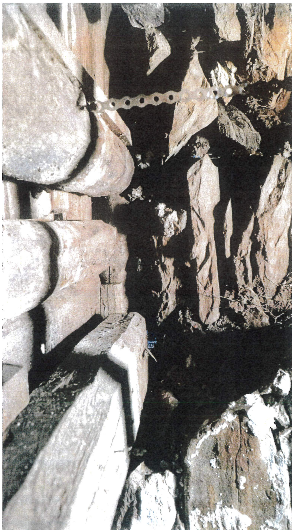
Bilde viser tre bærebjelker som henger kun i spikerfeste mot bunnsvillen. På bilde ser man at bunnsvillen i dette partiet henger i løse luften. Dette er grunnmuren mot nord.
