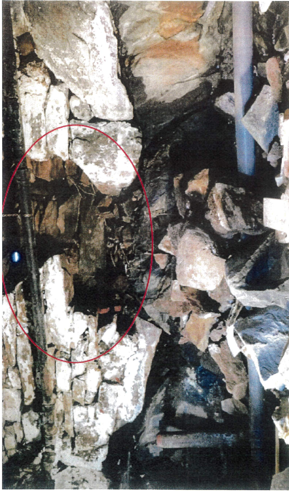
Bilde viser ett tredje parti av grunnmuren mot nord. Grunnmuren er også her plassert på et fjellparti som heller sterkt inn mot kjelleren. Her har også ett par holdsteiner skidd ut, noe som har medført at en større parti av grunnmuren har kollapse. hvor også her Området som er merket med en rød ring viser det området som har kollapse og omfatter et område på godt og vel en meter..
