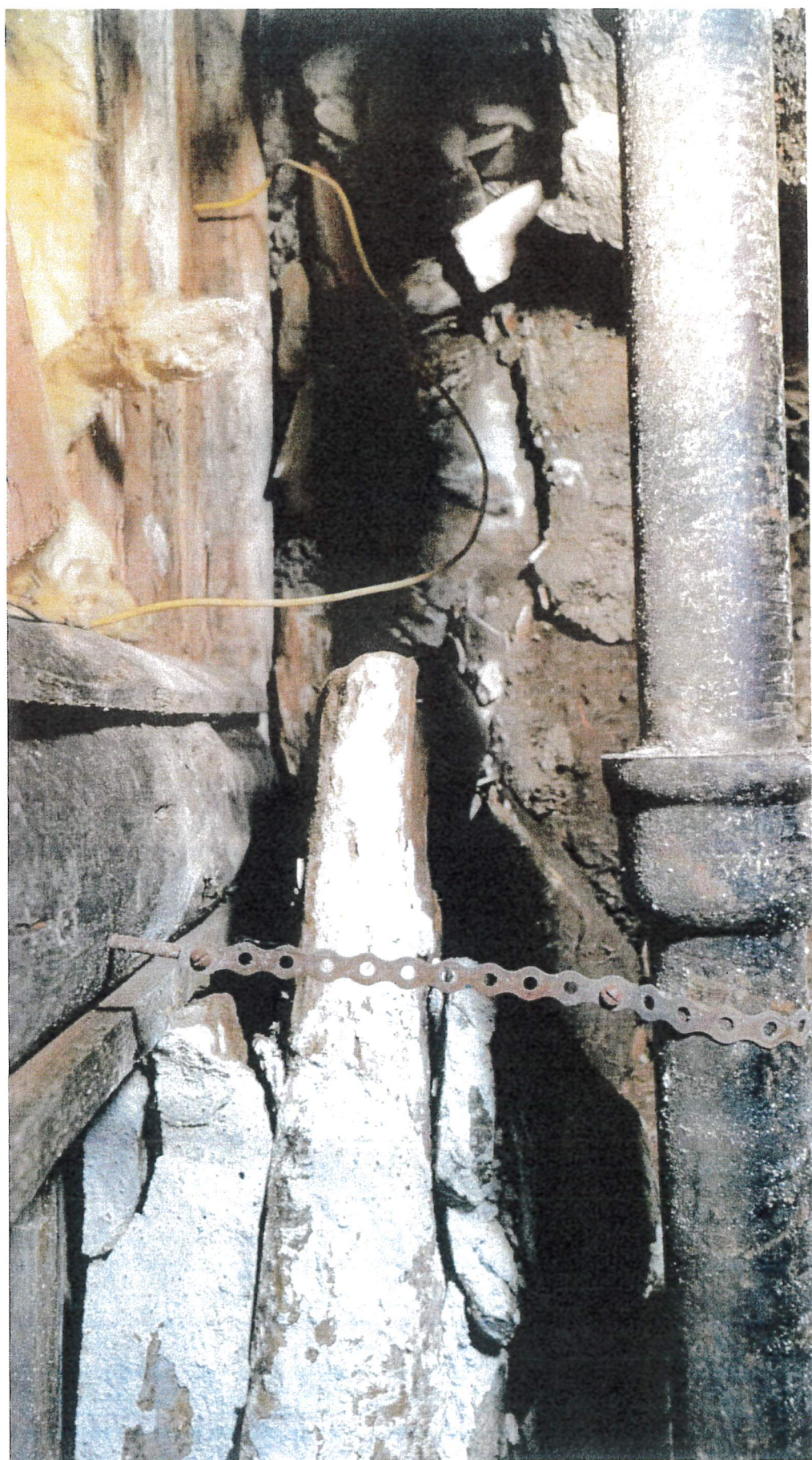
Bilde viser en bærebjeltene som henger kun i spikerfeste mot bunnsvillen. På bilde ser man at bunnsvillen i dette partiet henger i løse luften. Dette er grunnmuren mot nord.
