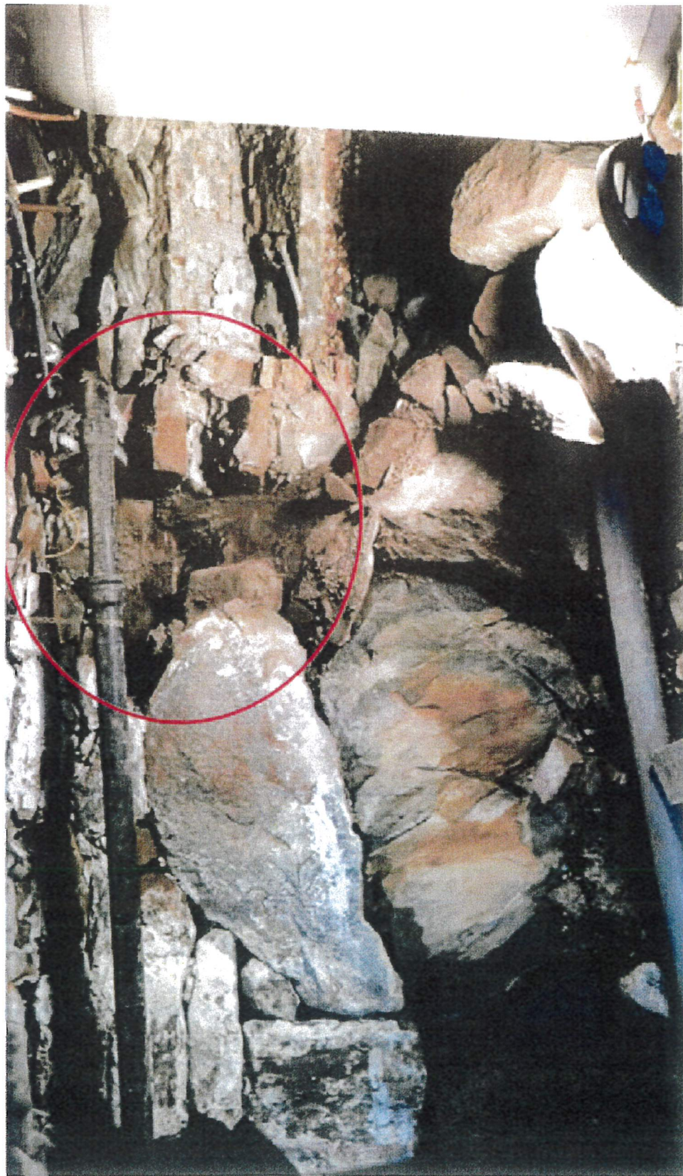
Bilden viser et annet parti av grunnmuren mot nord. Her er grunnmuren plassert på et fjellparti og hvor et større parti av grunnmuren også har kollapset og rast ut etter mange år med vanninntrenging. Siden fjellpartiet heller sterkt inn mot kjelleren har ett par større holdsteiner rast ut på grunn av manglende bindemiddel mellom steinene, tyngdekraften og trykket fra resten av grunnmuren. Området som er merket med en røde ringen viser det området som har rast ut og som omfatter et område på ca en meter.
