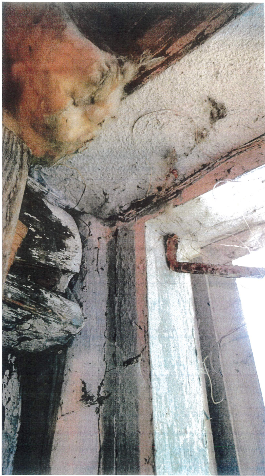
Bilde viser en bærebjelke som hviler på selve vindusrammen og ikke på grunnmuren som vil være det normale. Flere av bærebjolkene mot syd hviler på vinduskarmen for de tre kjellervinduene. Dette er grunnmuren mot syd.
