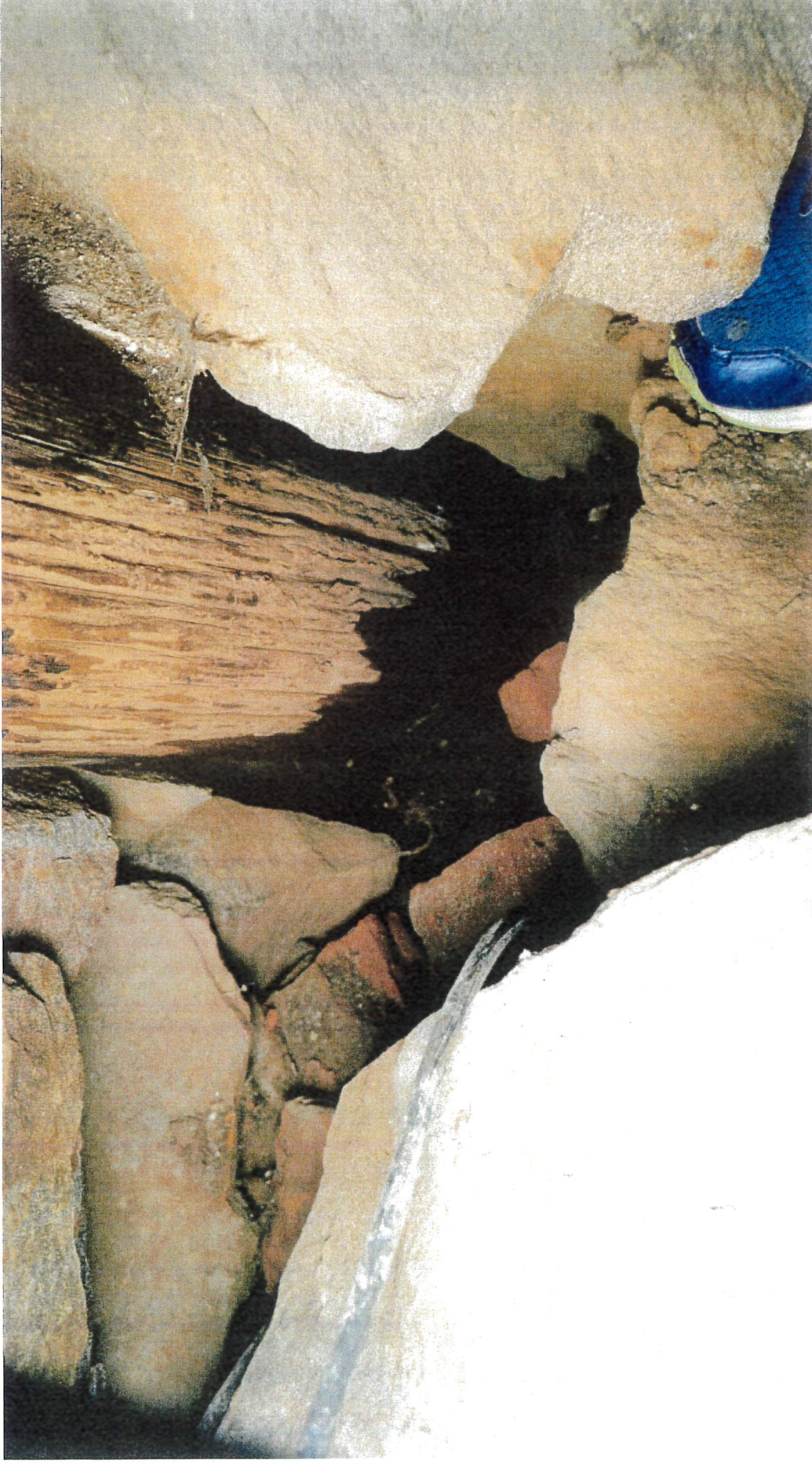
Bilde viser den andre gamle telefonstolpen som bærer mesteparten av den opprinnelige boligen. Begge har stått konstant i vann i mer enn 30 år noe som har resultert i at store deler av stolpen er svært svekket og hvor det bare er et tidsspørsmål før en av disse eller begge bryter sammen og hele den opprinnelige boligen kollapse. På bilde ses tydelig fuktmerker 50 – 60 cm opp på stolpen..
