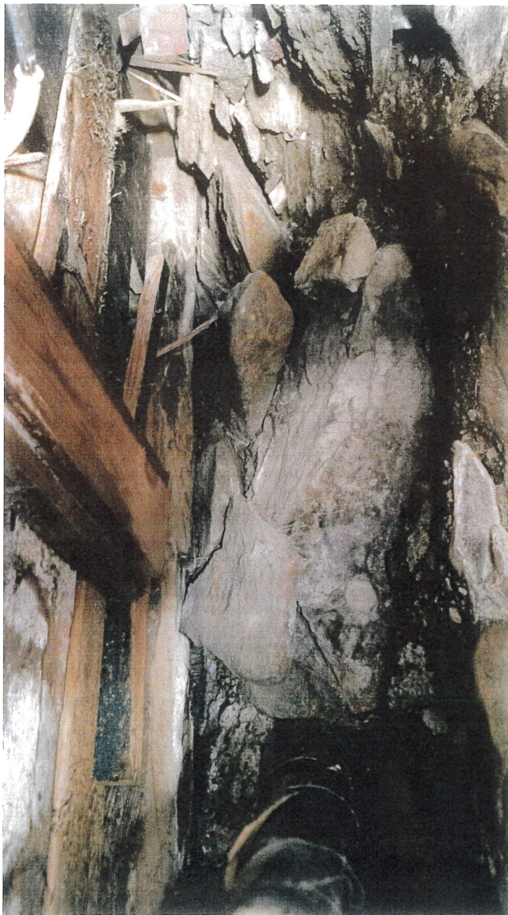
Bilde viser en bærebjælkene som henger kun i spikerfeste mot bunnsvillen. På bilde ser man at bunnsvillen i dette partiet henger i løse luften. Dette er grunnmuren mot nord.
