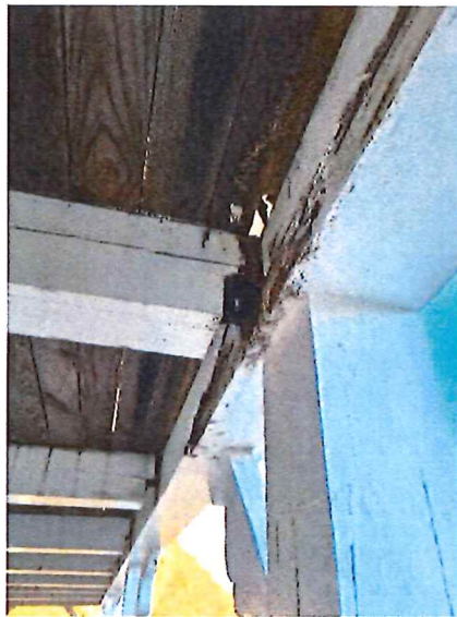
Disse mellomrommene med tilhørende råteskader skal absolutt ikke være der.
