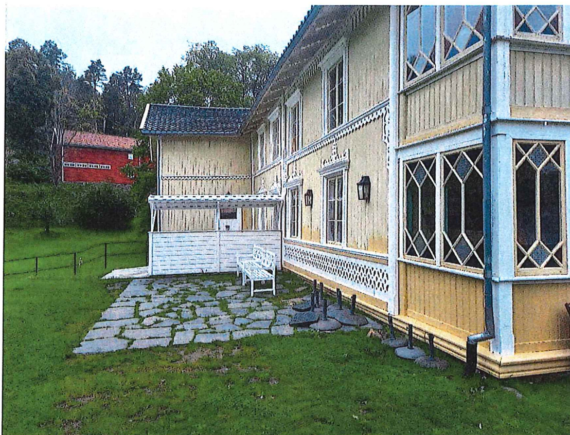
Nedre del av bygningen var veldig slitt og fortjente litt omsorg med linoljemaling.
