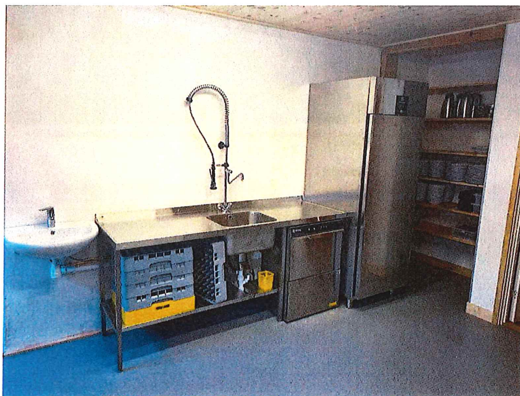
Skitten sone med håndvask, utslags-/spylevask og damp-vaskemaskin.
