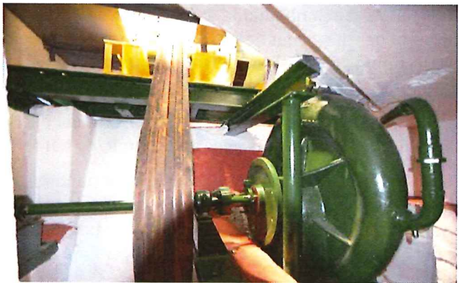
Etter et ansiktsløft og teknisk gjennomgang er den gamle dokkpumpa satt i drift
