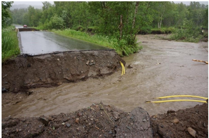
Veibrudd i Målselv i 2012 hvor kabler ble revet av. Foto Ole Asheim
