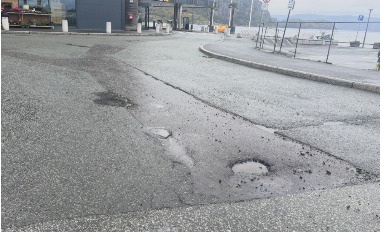
Vestersiden – innkjøring til Salt handelssenter, slitt dekke med hull og ujevnheter
