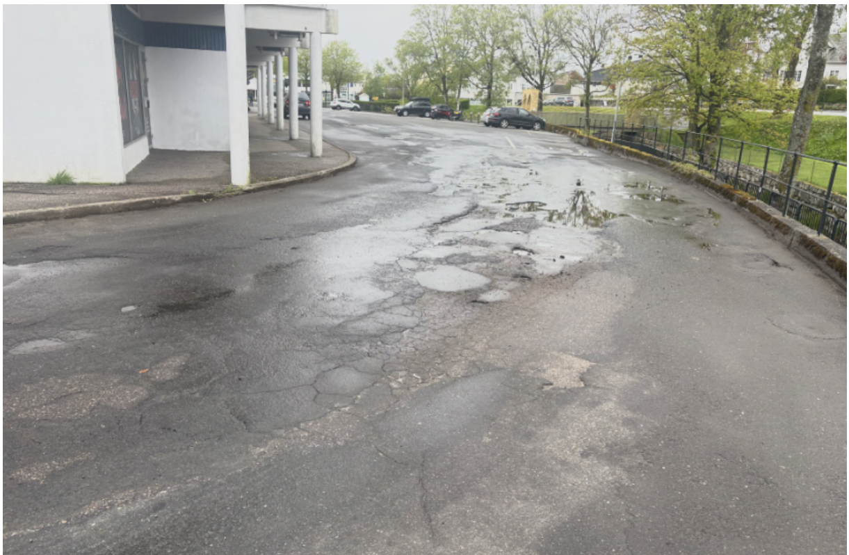
Olav Selvaags vei – svingen mot Selvaagparken, krakelert asfaltdekke med deformasjoner, setninger og tidligere reparasjoner
