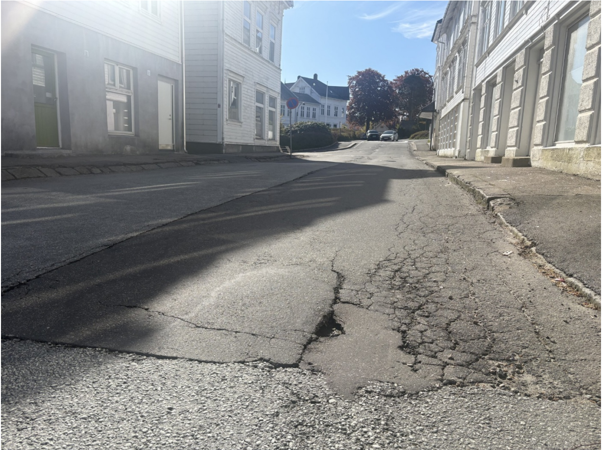
Listerveien (mot Nytorvet) – sprekkdannelser og deformasjoner i asfaltdekket (mai 2026)
