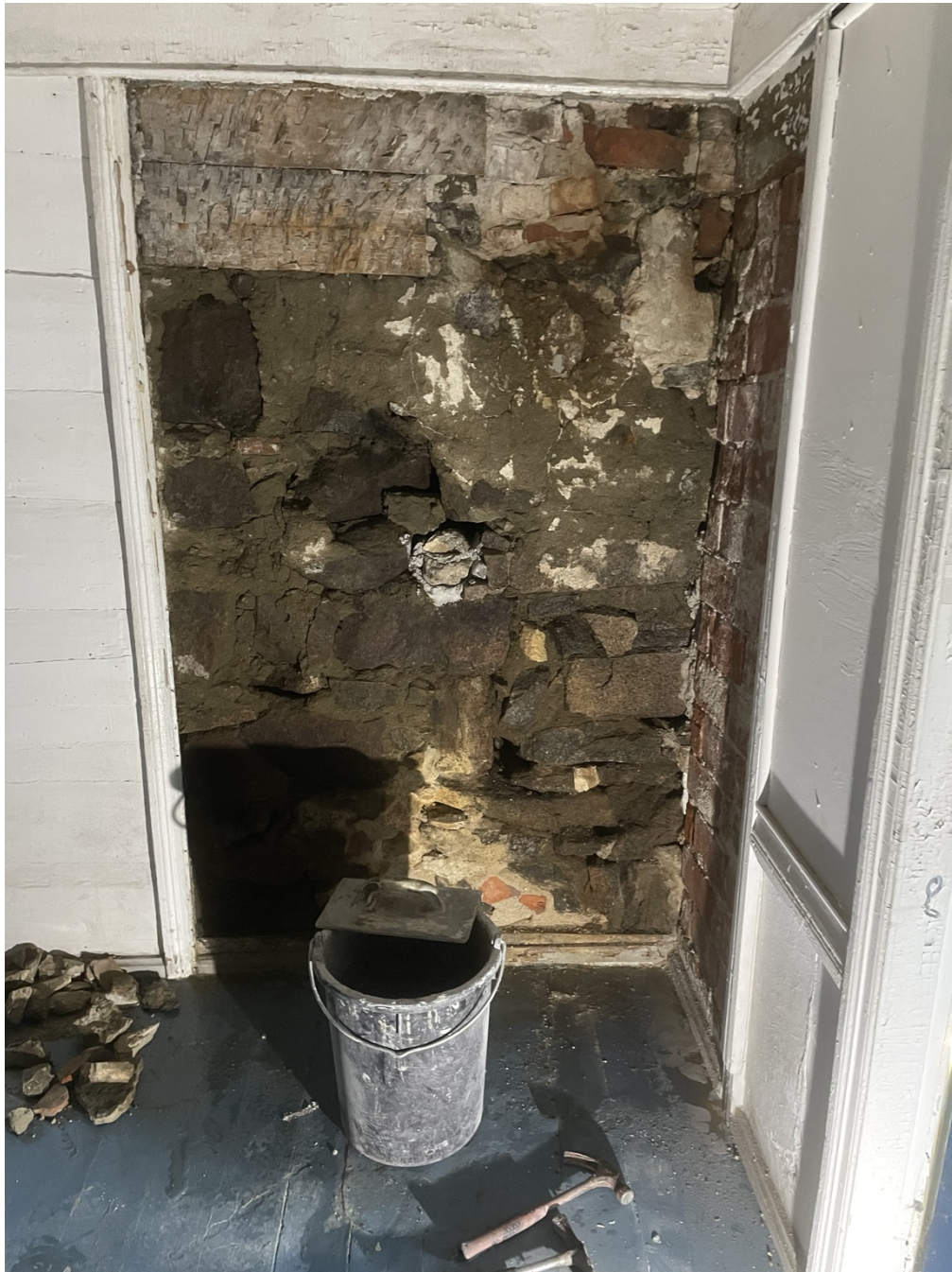
Strukturelle svakheter og åpninger dokumentert under avdekking.
