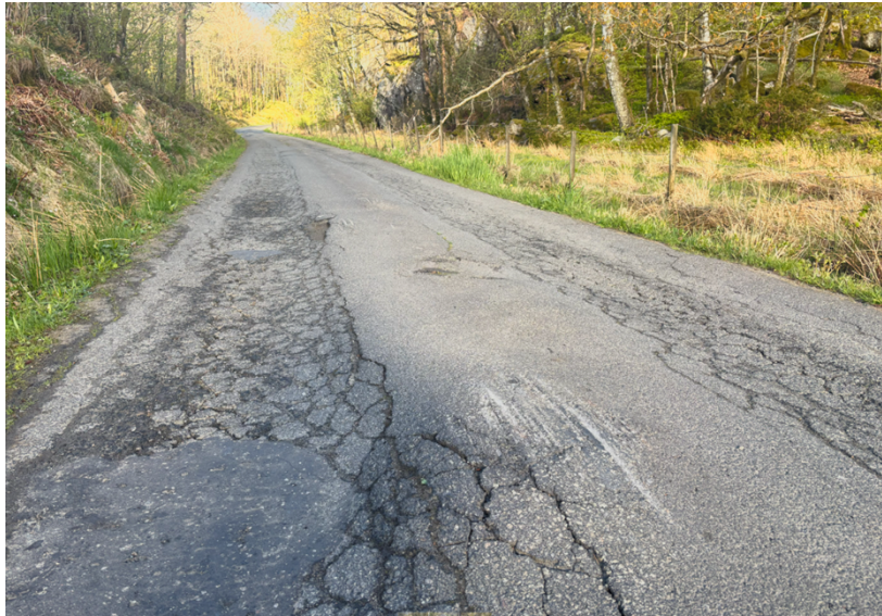
Illustrasjonsbilde: Vigeveien – betydelig spordannelse og deformasjoner som indikerer svekket bæreevne langs hele strekningen
