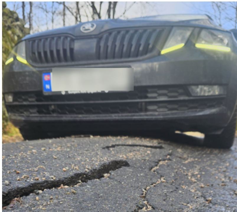
Illustrasjonsbilde: Kårikstadveien – oppsprukket og oppbrutt asfaltdekke med åpne sprekker og oppbrytning
