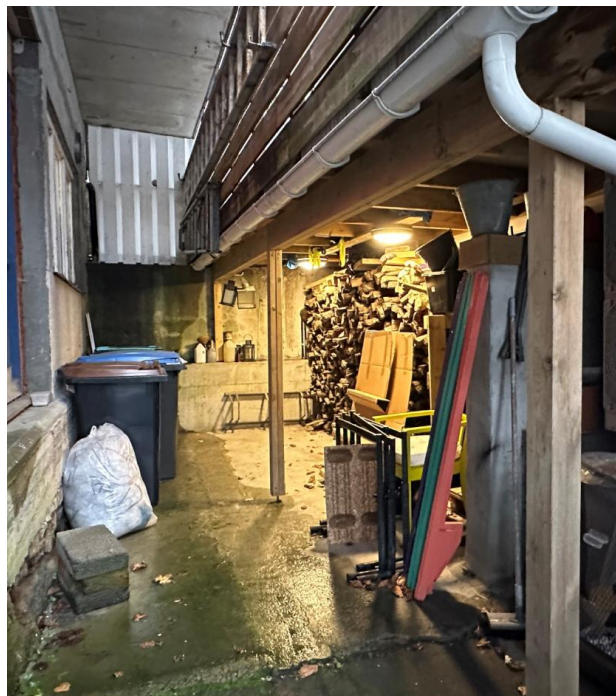
Figur 25: Eksempel på utvendig brennbart materiale mellom bygninger.
