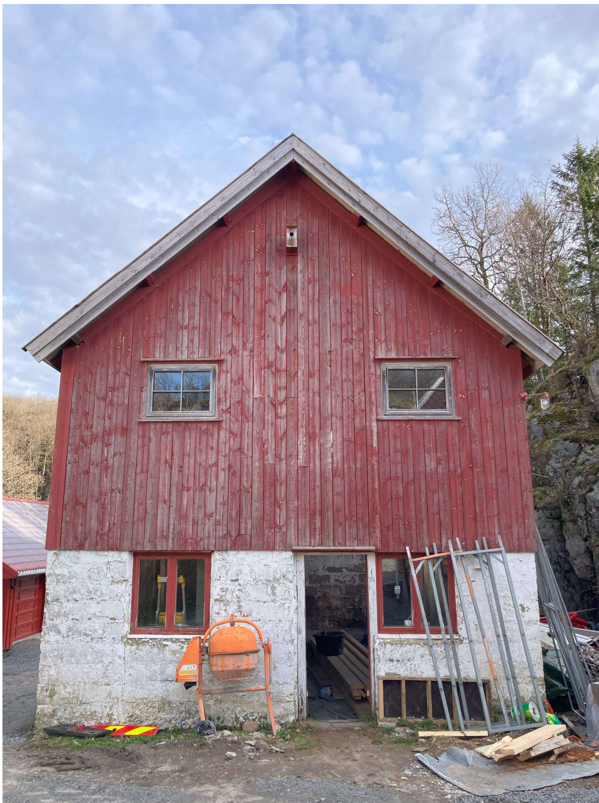
Bilde 3: Foto av fasade sør som viser den almenne tilstanden til løa.
