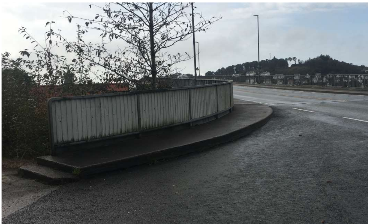
Tett platekledning forslås erstattet av gjennomsiktig kledning av glass/plast
