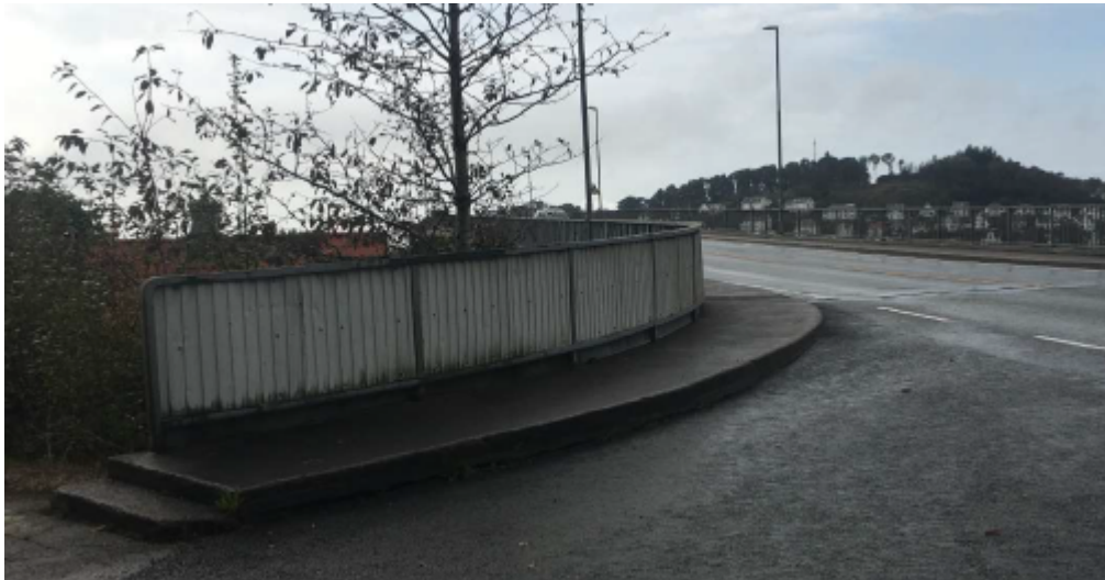
Figur 7 Stolpene i rekkverket vil være et hinder for frisikt i retning av byen selv om de tette plater byttes ut med plexiglass.
