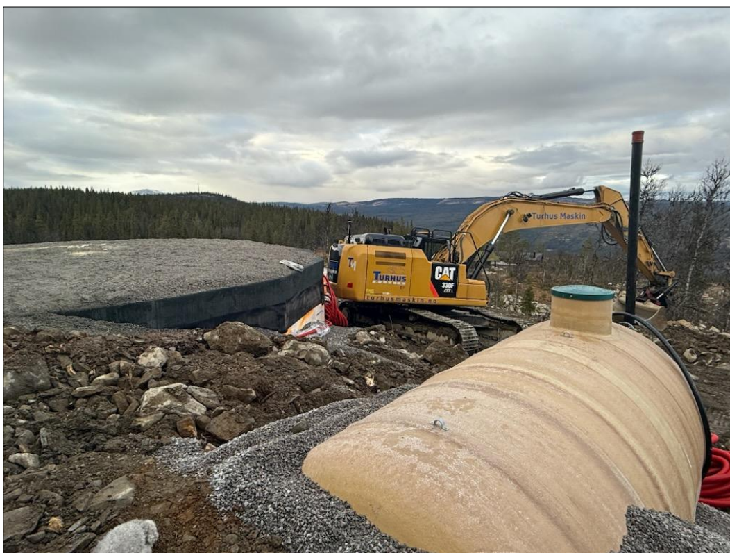
Figur 3-9. Ved Gol fjellandsby er det montert høydebasseng av prefabrikerte betongelementer ( 335 \text{ m}^3 ). I tillegg er det montert en GUP tank som kan benyttes ved vedlikehold i hovedbasseng om tømning er nødvendig. Brannvannsreserve vil da ikke være tilgjengelig.
