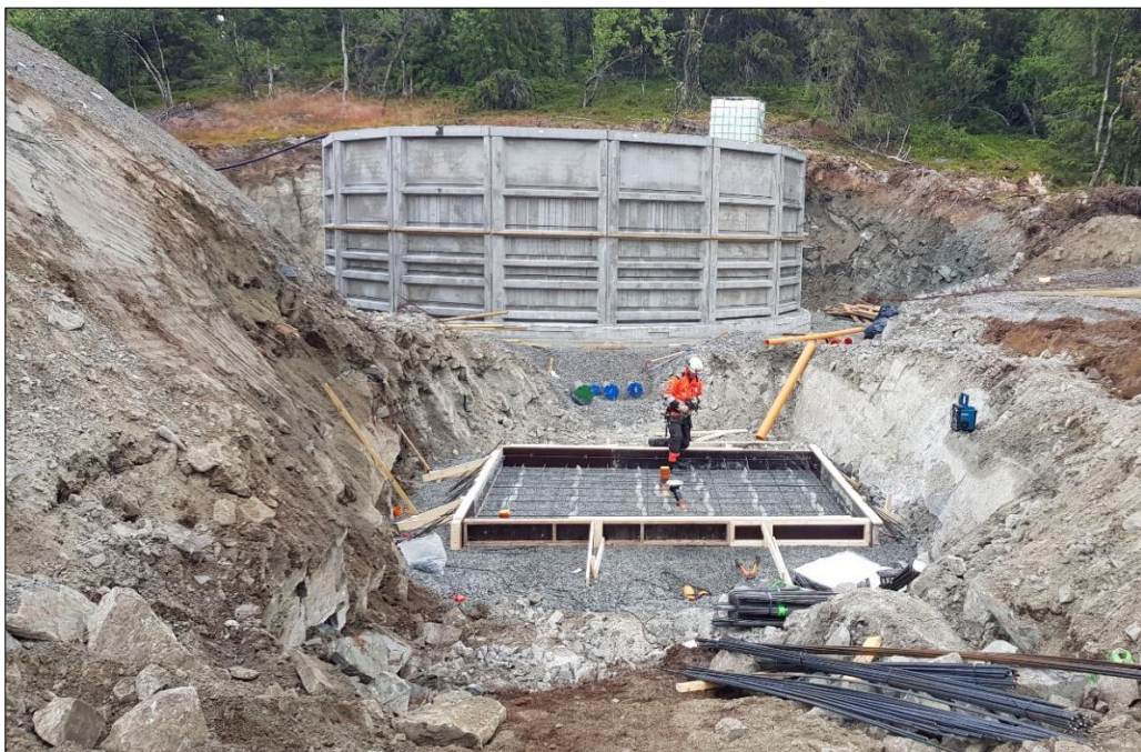
Figur 3-7. Eksempel på nedgravd basseng med frittstående ventilkammer fremfor basseng, Tverrlia Nesfjellet. Basseng med prefabrikerte betongelementer
