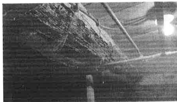
Skade på bærende konstruksjoner etter råte/ skadedyr.
