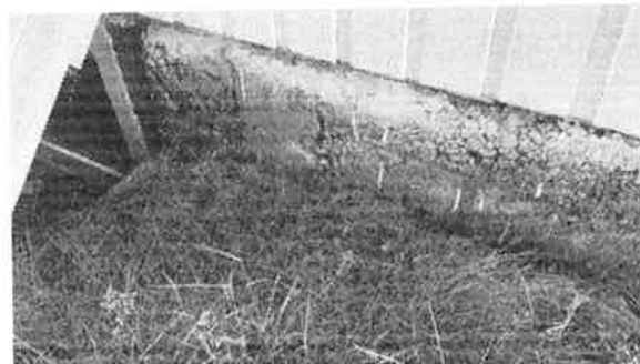
Skade/ slitasje på grunnmur.
