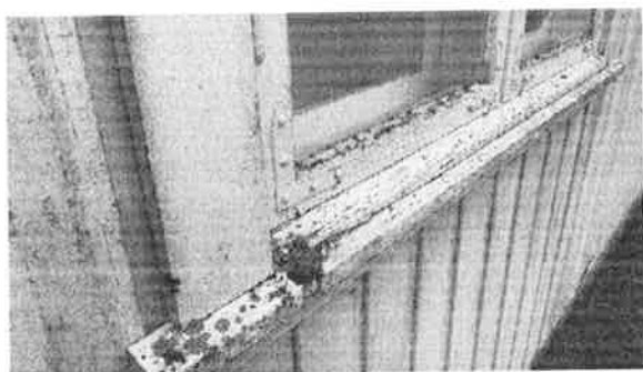
Skade/ slitasje/ råde på vindu.
