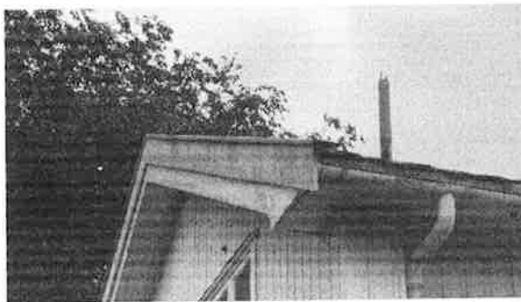
Skade/ slitasje på vindski.
