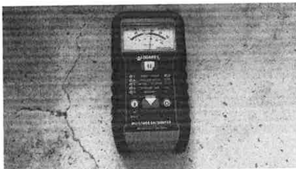
Ved fuktsøk på gulv er det registrert måleverdier som indikerer fukt.
