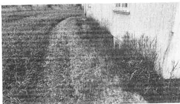
Manglende fall bort fra grunnmur
