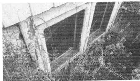
Skade/ slitasje på vindu.
