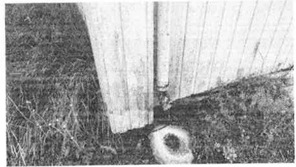
Manglende bortledning av vann fra nedløp.
