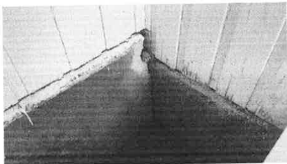
Overgang som har glidd fra hverandre.
