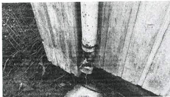
Skade/ slitasje på yttervegg.
