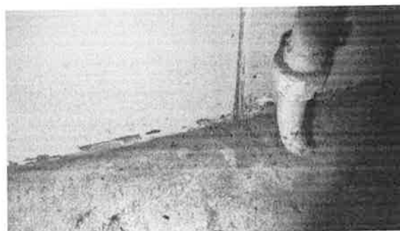
Fuktskade på veggplater.
