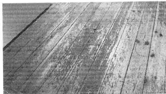
Skade/ slitasje på overflater.
