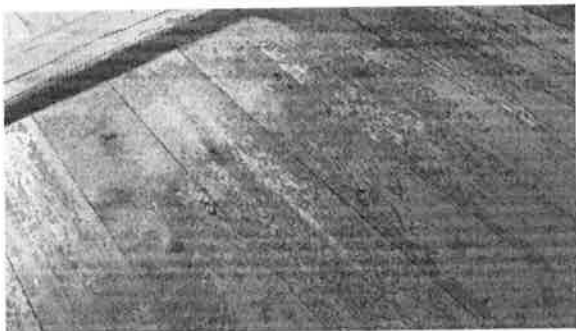
Skade/ slitasje på overflater.
