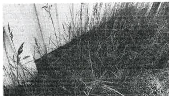
Liten avstand mellom kledning og terreng.
