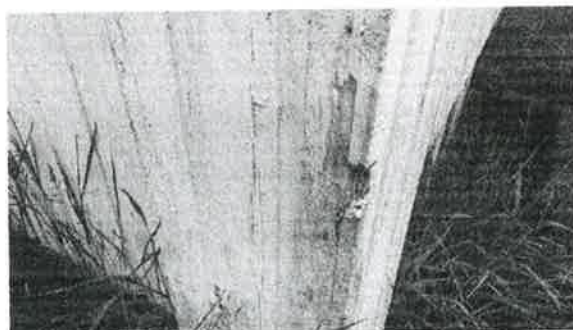
Råteskade på yttervegg.
