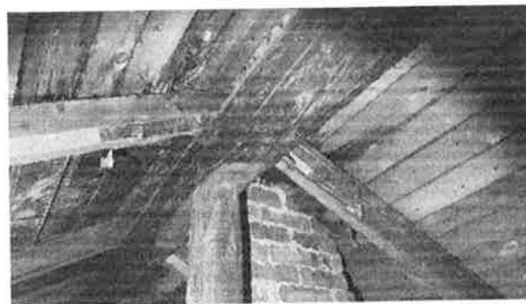
Undertak med fukt/ råteskade.
