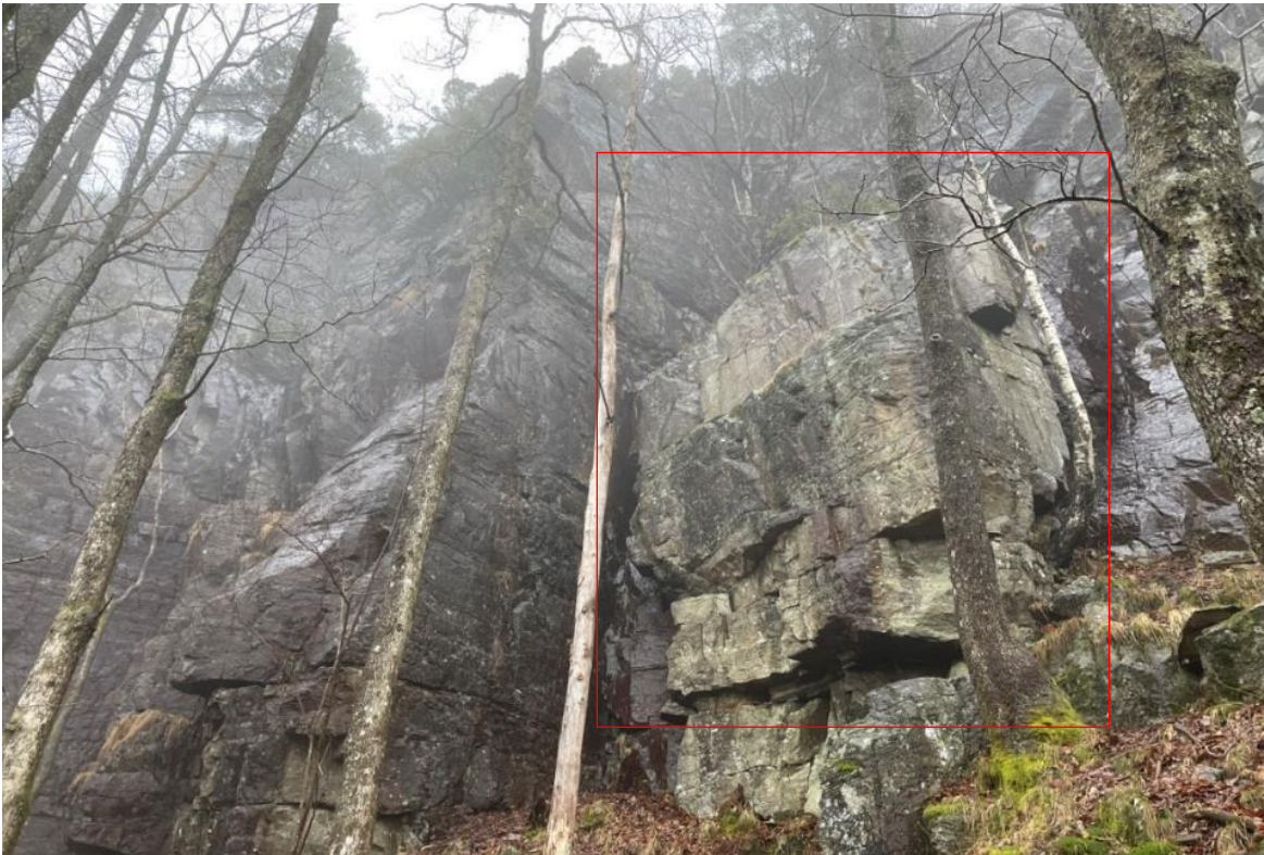
Bilde 13. Ustabil bergparti. Informasjonspunkt nr. 8 i vedlegg 5. Bildet er tatt mot nordøst.
