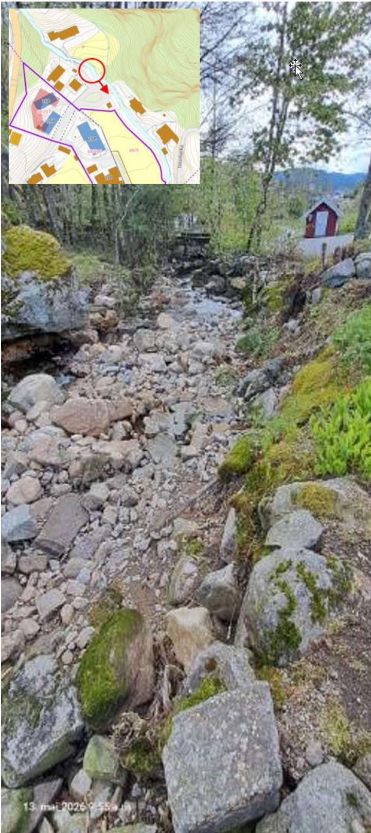
Figur 5: Bilde fra lokal beboer. Det største blokkavsetningene stammer fra kollaps av støttemuren fra Søylandsveien 24.
