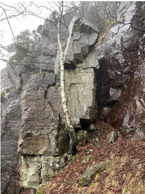
Bilde 14. Ustabil bergparti. Informasjonspunkt nr. 8 i vedlegg 5. Bildet er tatt mot nordvest.
