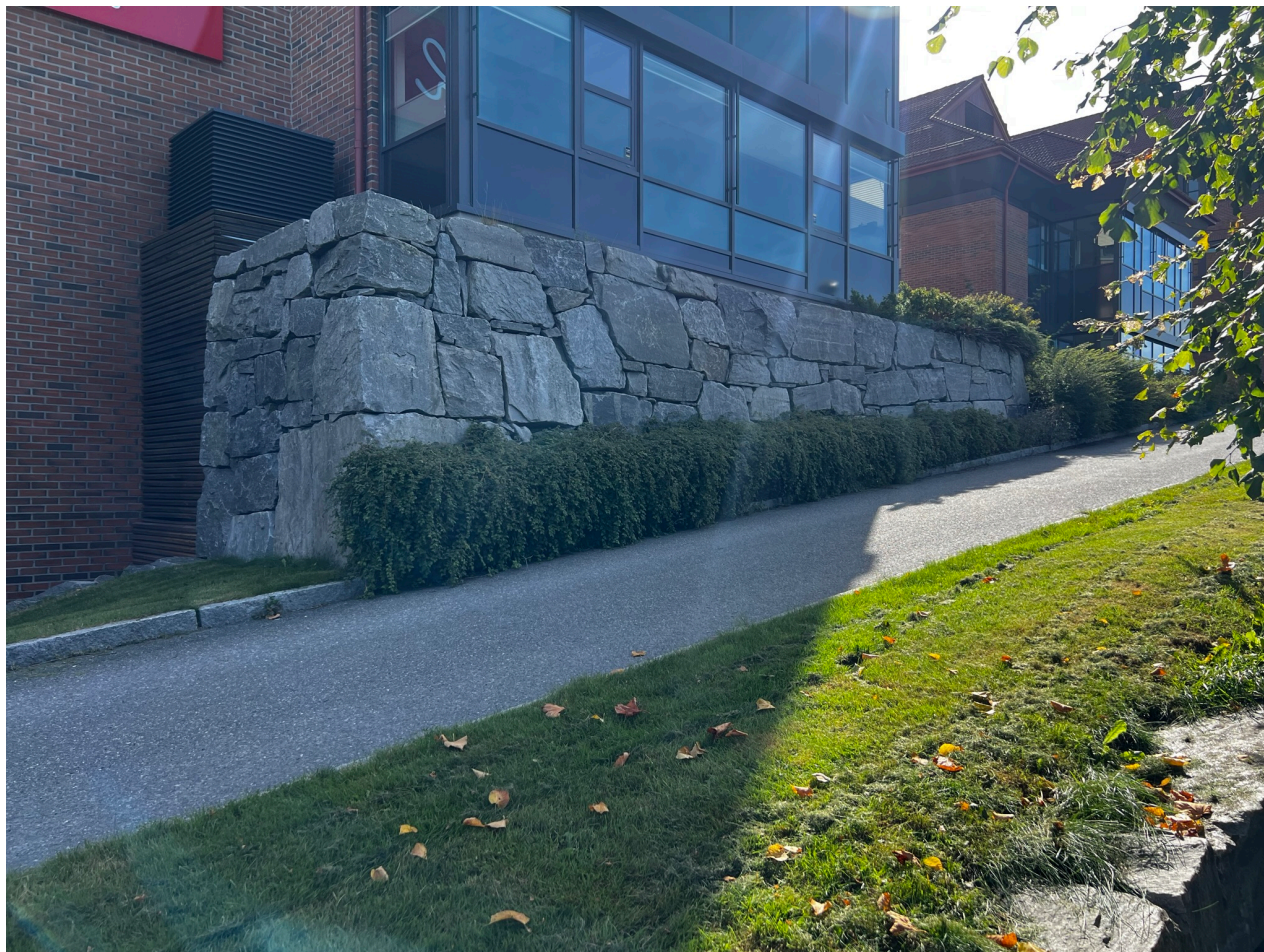
Figur 26 Vegetasjon i bunn i overgang mellom asfalt og mur
