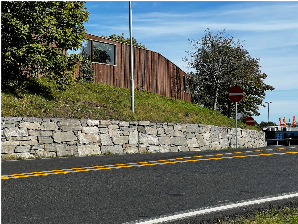
Figur 21 Mur i Vesterledkrysset i Grimstad
