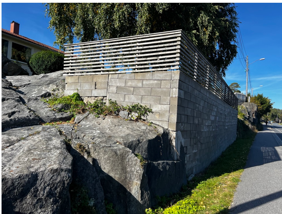
Figur 1 Grimstad. 3 meter høy mur som ikke har en god utforming.
