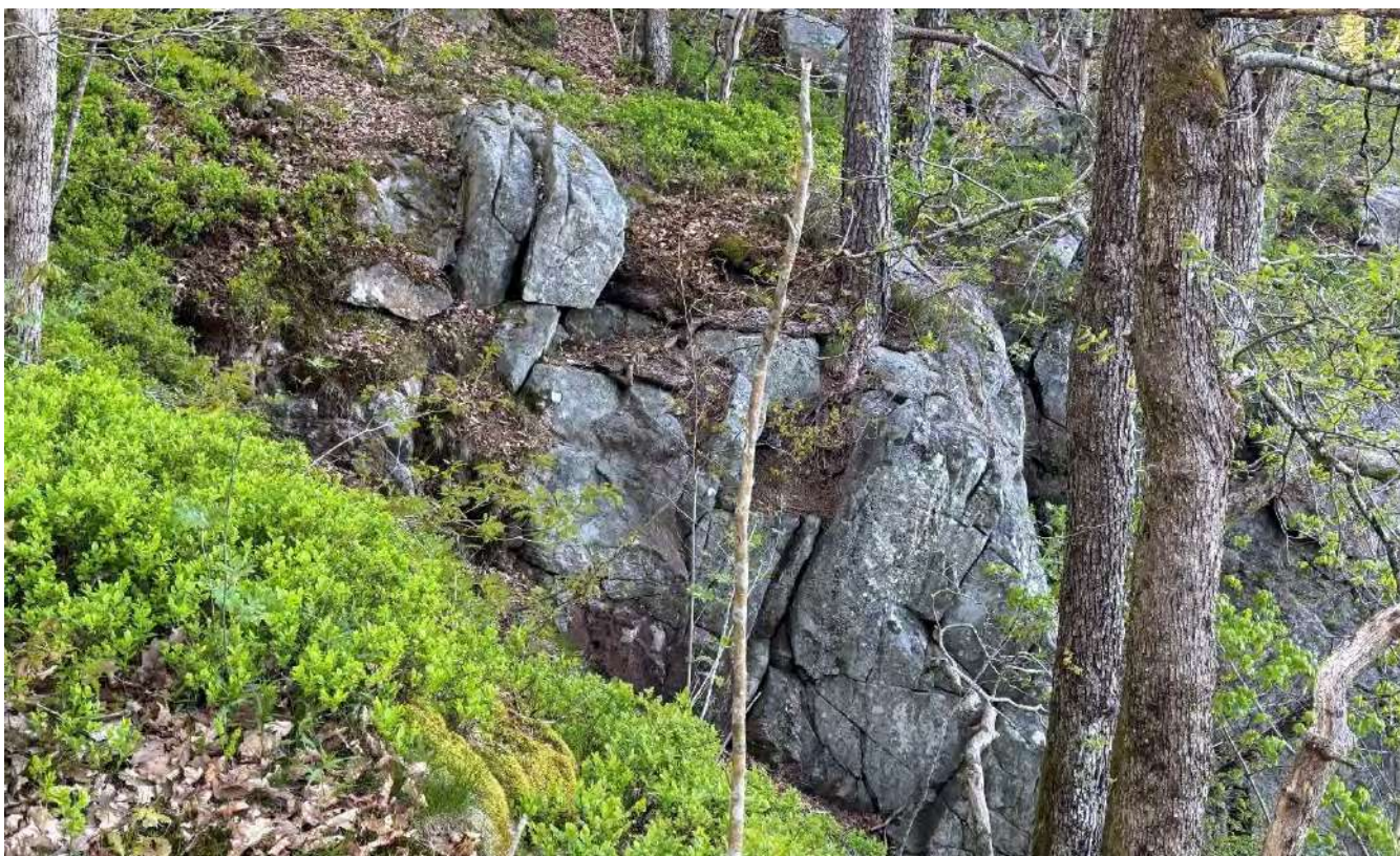
Figur 38 Infopunkt 17. I det høyereliggende terrenget vest i kartleggingsområdet ble det i tillegg observert én fremtredende blokk, som sannsynligvis kan utløses. Det anbefales å fjerne blokken for å forhindre fremtidig utløsning som kan ramme kartleggingsområdet. Bilde av Skrið as.
