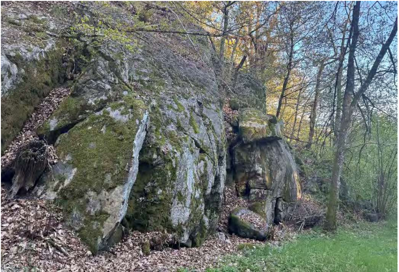
Figur 39 Infopunkt 18. Nord i kartleggingsområdet observeres blokk som kan løses ut, men er ikke en vesentlig fare for kartleggingsområdet. Det anbefales å fjerne blokken. Eldre steinsprang avsatt i underkant. Bilde av Skrið as.
