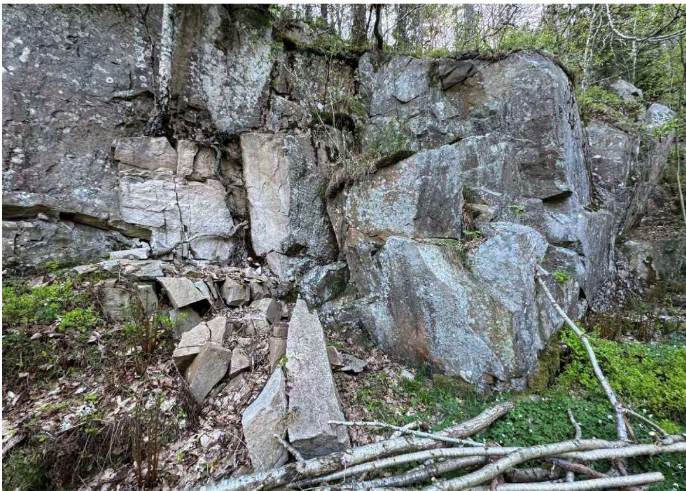
Figur 37 Infopunkt 16. På grunnlag av tett sprekkemønster samt svært begrenset fallhøyde, vil ikke steinsprang utløst ved turstien medføre skadepotensiale. Bilde av Skrið as.
