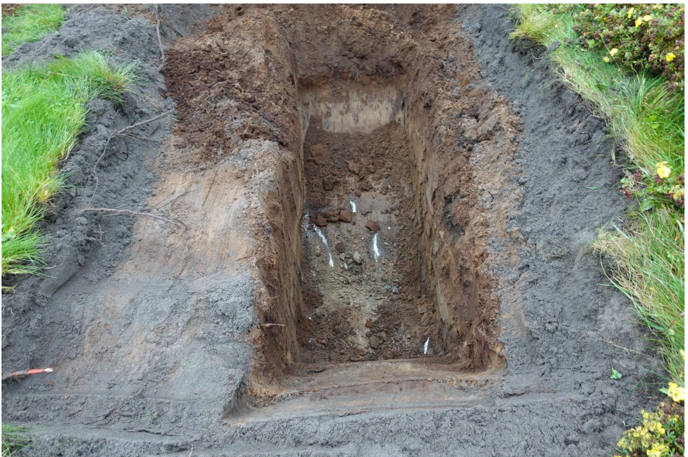
G5, gravd ned til kulestein. Kom ikke vann inn med en gang på dette nivået.
