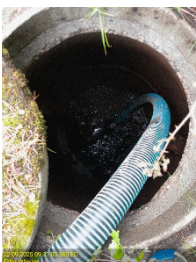
Bilde av dagens tank.
