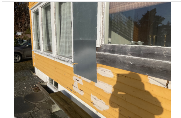
Skade i vegg og i vindu
