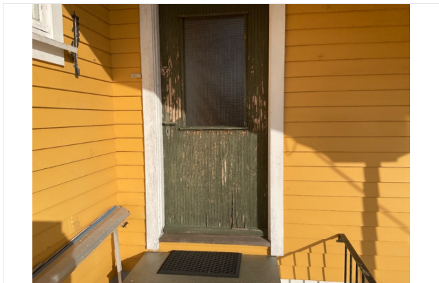
Skade i dør
