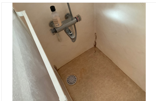
Råteskade i dusj.
