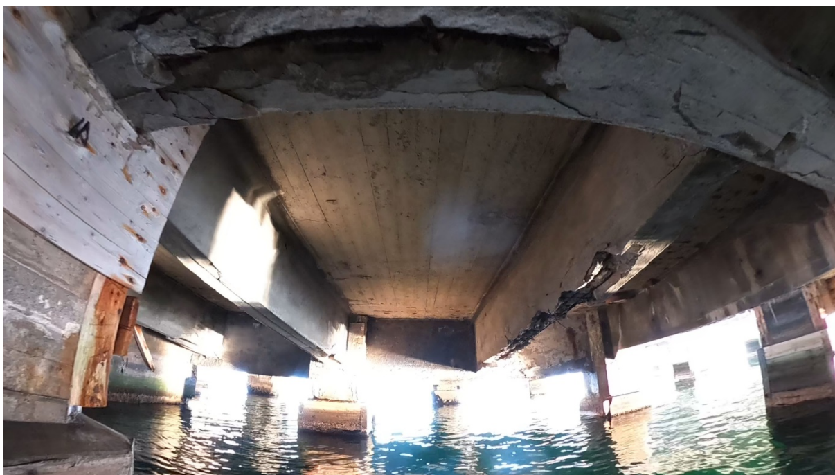
Figur 4-32: bygningsskader på Kai B
