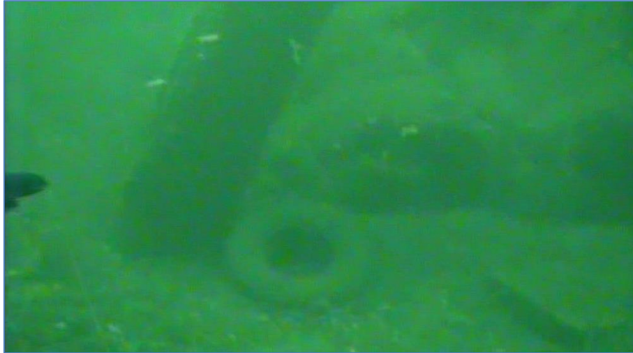
Bilde 19 - 2m dypt søkk i sanden inn mot den ytterste pilaren.
