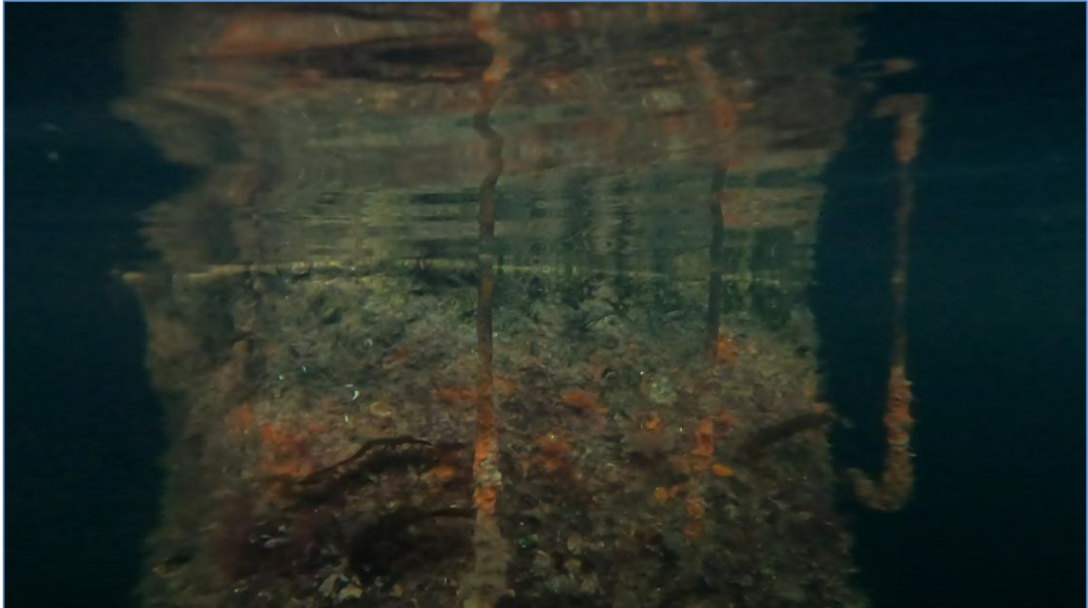
Bilde 43 - Skadet søyle under vann.
