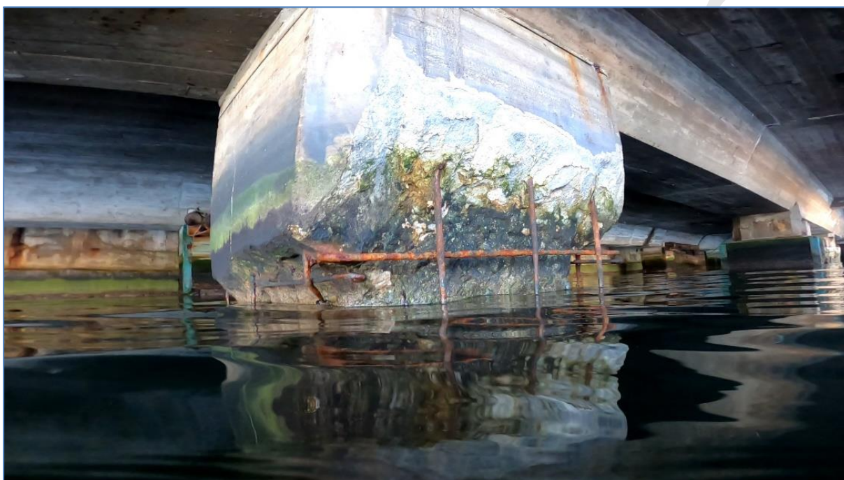
Bilde 42 - Bilde av skadet søyle på øst siden av Torskeholmen.
