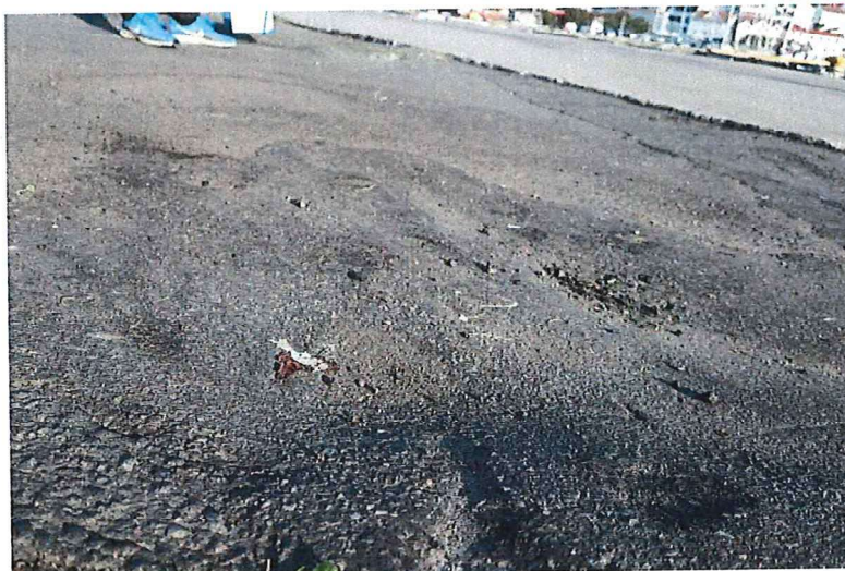
Figur 1: Fare for dannelse av hull og kollaps i slitelag på parkeringsarealer bak kai C
