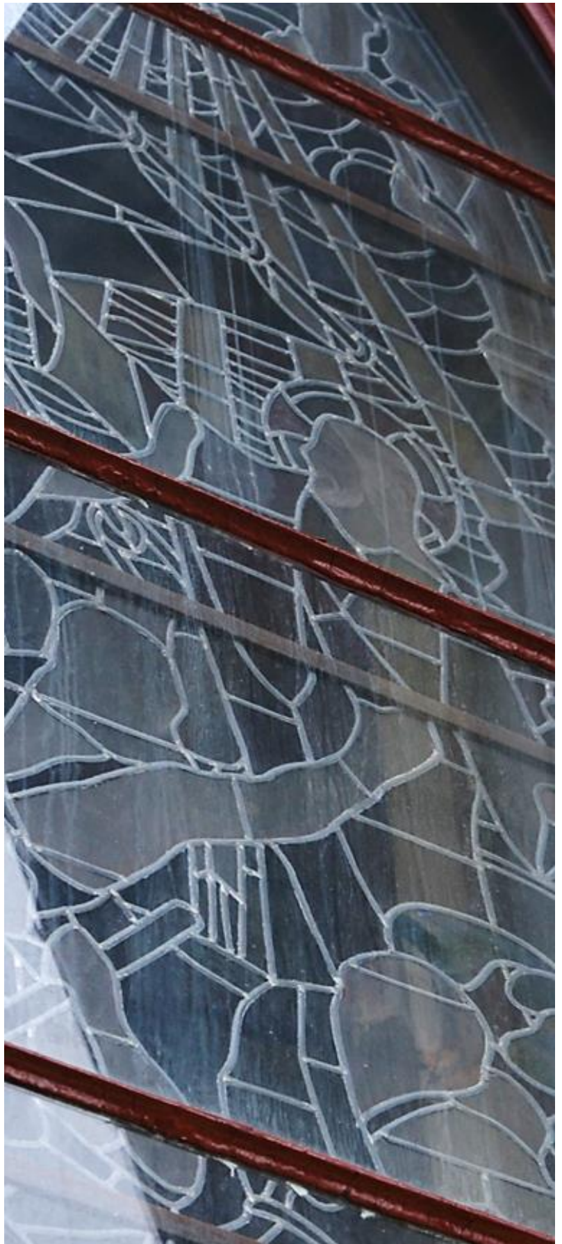
Rennemerker på beskyttelsesglasset, fra vindu Ø2
