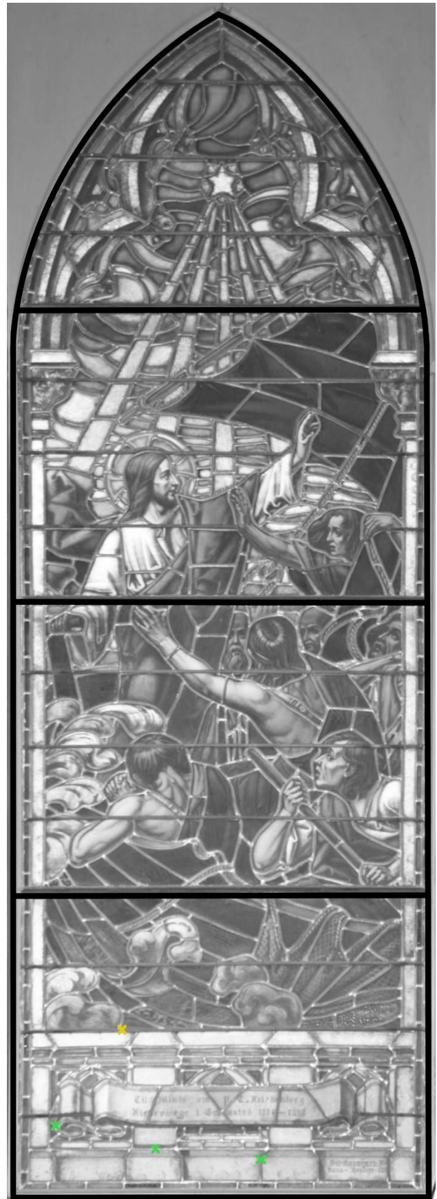
Illustrasjon av skadene observert på vindu Ø2.
