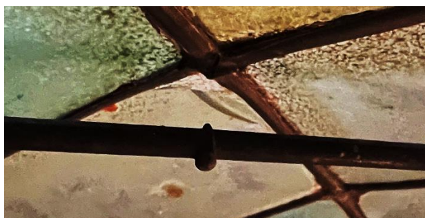
Skade på felt a, sett ovenfra. Avstanden mellom stormstag og glassmalerifelt har oppstått på grunn av en skade. En glassbit mangler fra den lyse glassbiten.
