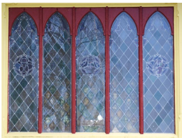
Beskyttelsesvindu på vindu S1.
