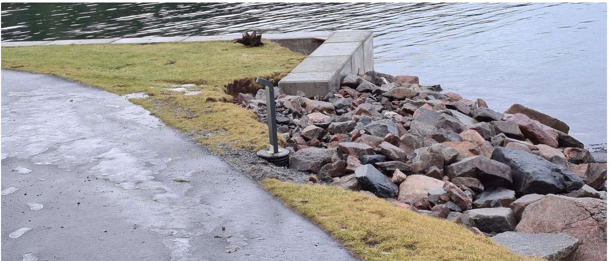
Figur 121 - Skade på eksisterende kyststien (Foto: Moysand familie camping)
