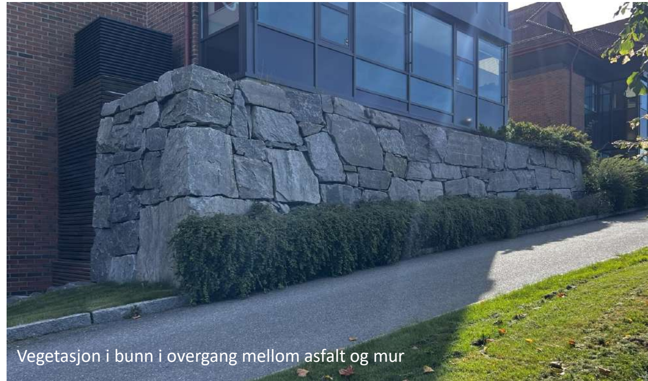
Vegetasjon i topp som dekker synlig murflate
