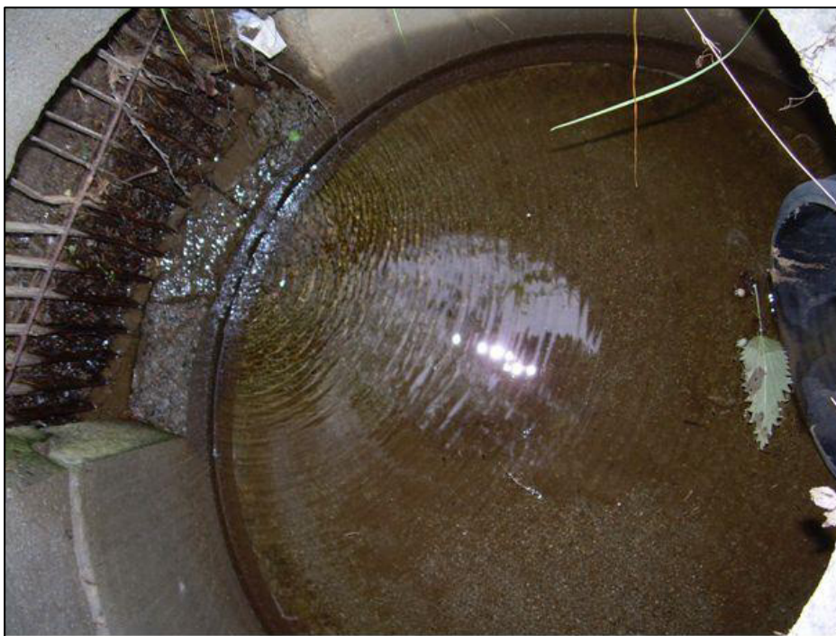
Figur 6: Bekkeinntak med rist. Betongkum, DN1200. Overvann føres til Ø400 PVC ledning.
