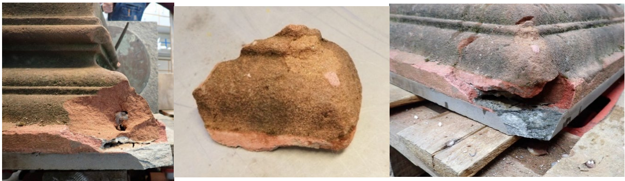
Figur 8) Foto t.v.: Basen har hjørneskader med skader i både skifer og sandstein. Foto i midten: Den løse delen i sandstein er bevart og (foto t.h.) ble limes tilbake på plass.
