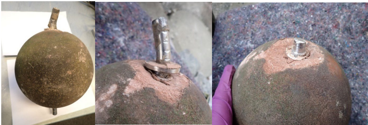
Figur 5) Foto t.v. og i midten: Kun én av de runde, rustfrie dyblene er deformert. Foto t.h.: Etter pinnen er kappet ned.
