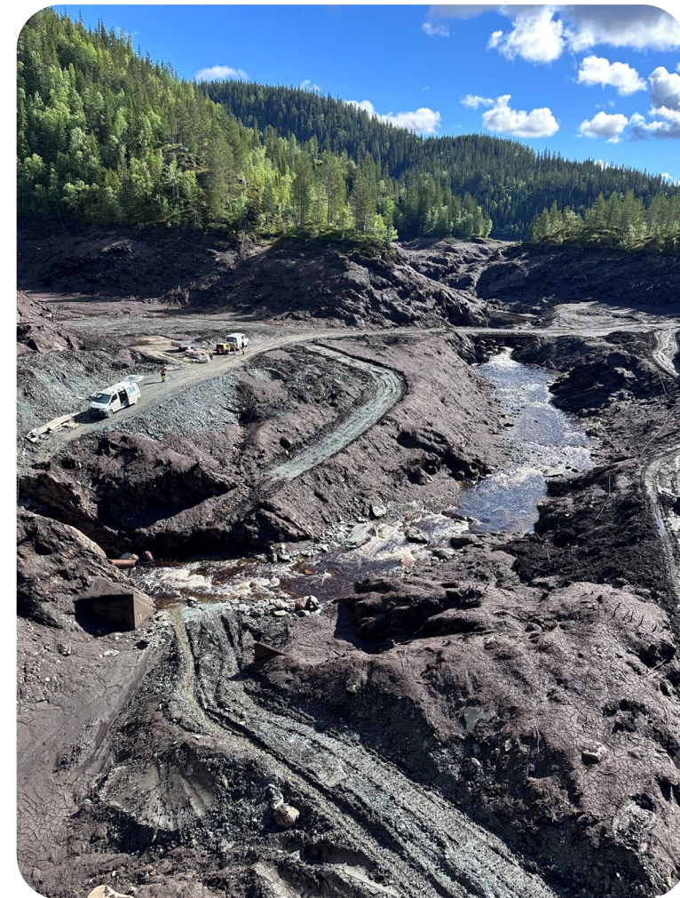
Dam Sokna - omløpsluke
