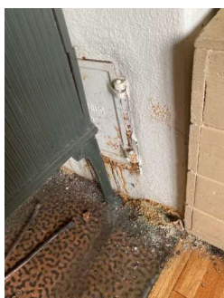
Vedovn er plassert helt inntil sotluke og brannmur.
