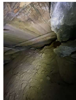
Kort avstand mellom terreng og trekonstruksjon, med fare for skader.
