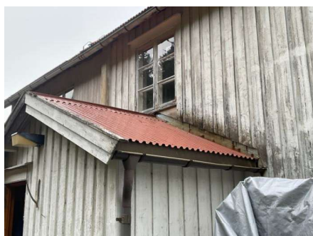
Utvendig panel er slitt.
