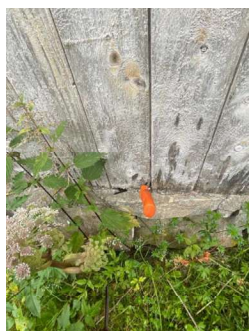
Stedvis råteskader i utvendig kledning.
