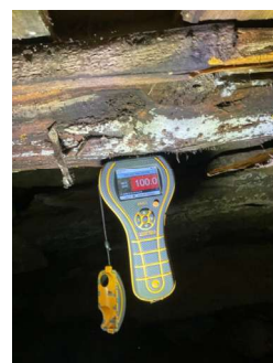
Fuktmåling i krypkjeller. Fullt fuktutslag.
