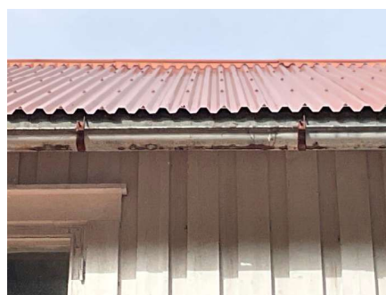
Noen småskader og stedvis manglende og løsnende spiker i tekkingen.
