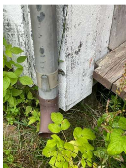
Takvann er ikke ledet bort fra grunnmuren.
