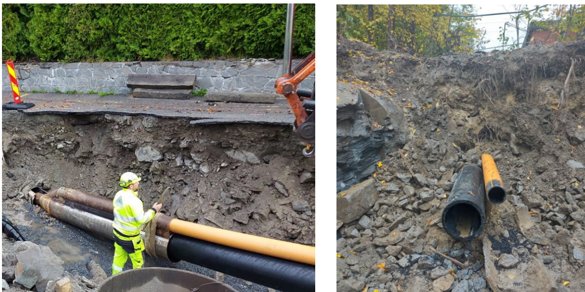
Figur 18 Eksempel på dobbeltblokking ved omlegging fra fellesledning til separate spill- og overvannsledninger.
