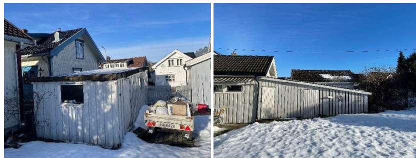
Tak på garasje og utvendig bod er i dårlig stand.
