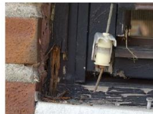
Foto nr. 2-7 Råteskade på vinduskarm
