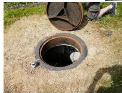
Foto nr. 4-13 Utvendig kum for springvann m/ luftestuss
