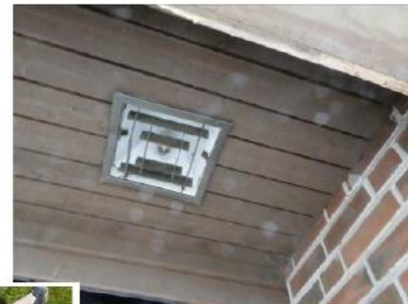
Foto nr. 4-20 Typisk utomhus lysarmatur under spring
