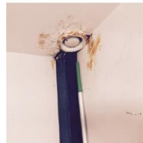
Foto nr. 3-31 ventil med tegn til fuktskade
