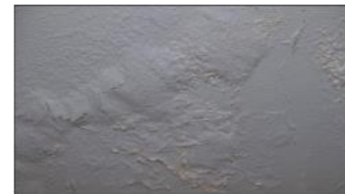
Saltutslag bak malingssjikt
