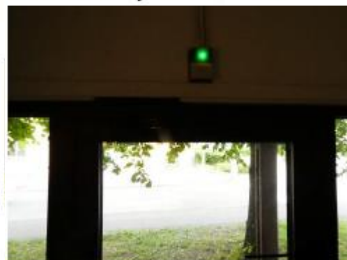
Foto nr. 4-22 Gammel NØD-lys armatur, som utgangsmarkering
