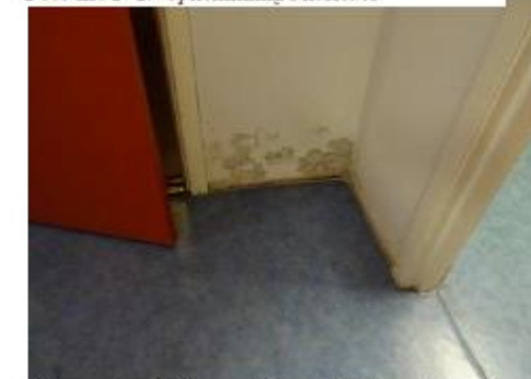
Foto nr. 2- 17 Noe malingsavskalling på vegg i kjeller
