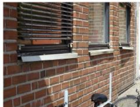
Foto nr. 2-10 Vannbrett.
