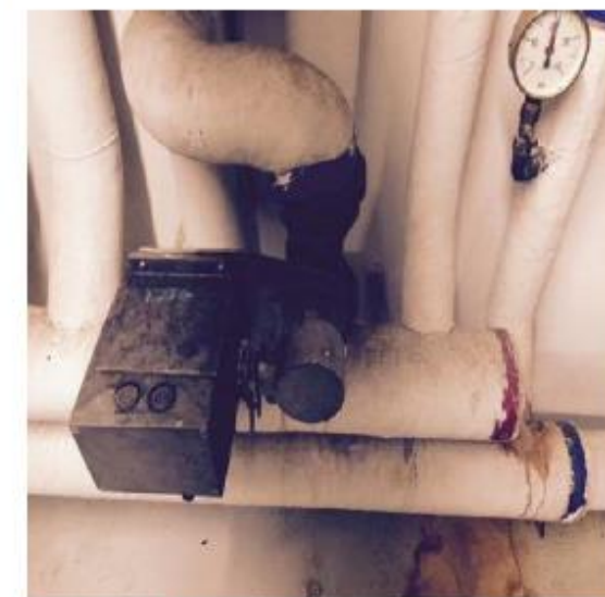
Foto nr. 3-5 Fyrrom utstyr utgått levetid.
