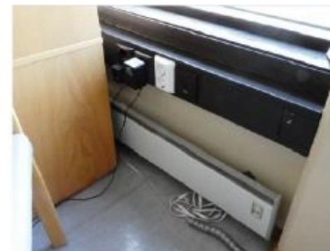
Foto nr. 4-25 Panelovn bak skap
