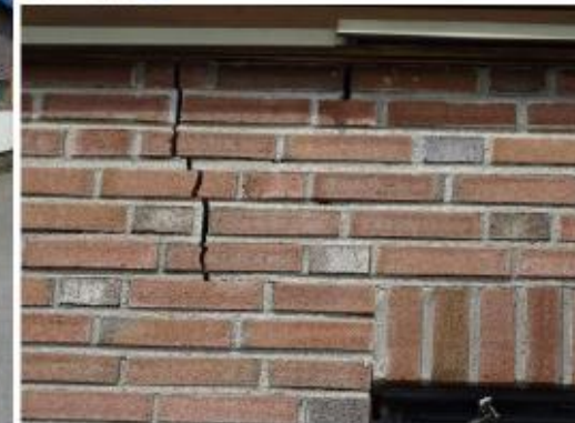
Foto nr. 2- 3 Oppsprekking i teglstein
