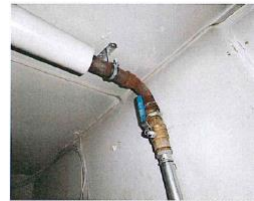
Bilde nr. 3.12 Rustent rørbend
