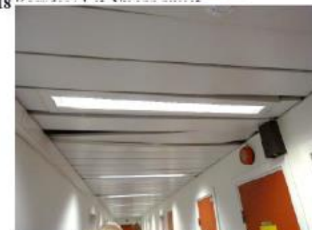
Foto nr. 2- 29 Spilehimling i korridor
