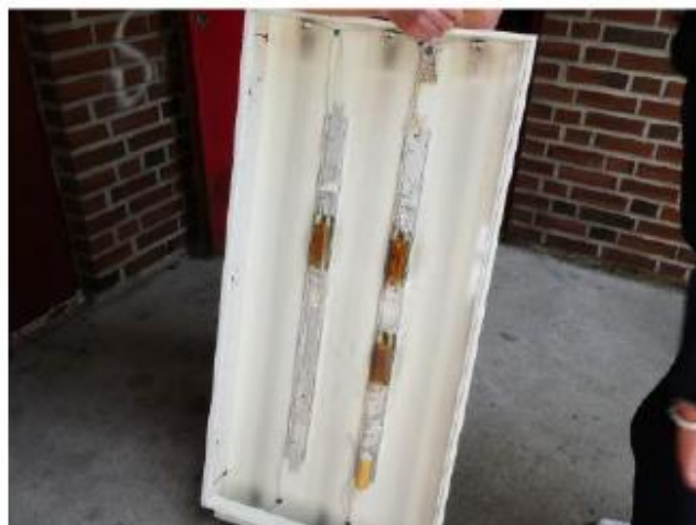
Foto nr. 4-18 Gammel lysarmatur, med PCB-innhold
