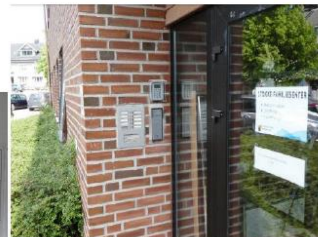
Foto nr. 4-32 Utstyr for adgangskontroll mm ved hovedinngang
