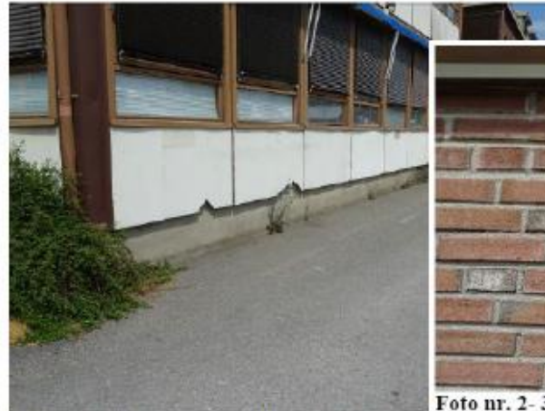
Foto nr. 2- 5 Skader på fasadeplater
