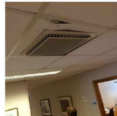
Foto nr. 3-48 lokaler for NAV i 1. etg med ventilasjon. Noe vedlikehold nødvendig.
