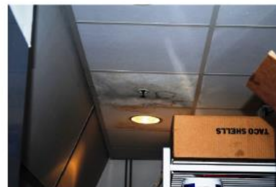
Fuktskade lager på kjøkken
