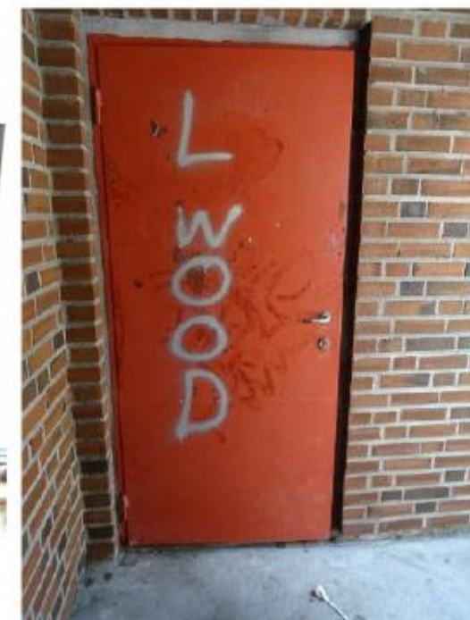
Foto nr. 2-14 Ståldør med tagging
