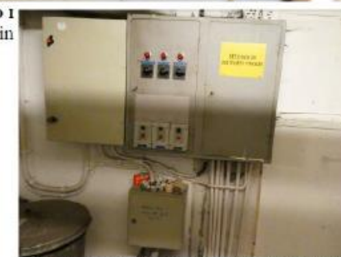
Foto nr. 4-15 Fyrtonnet m/ el-tekniske panel (for femine)
