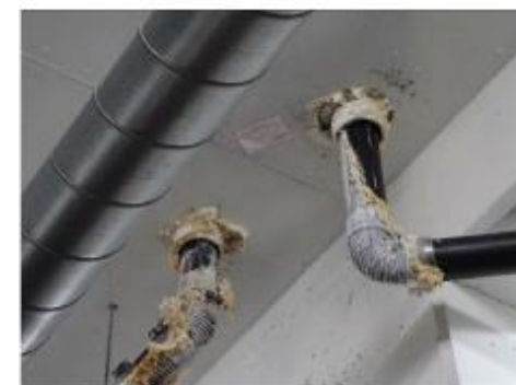
Foto nr. B22 Lekkasje i gjennomføringer i dekke.
