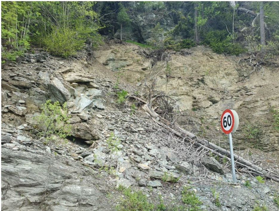
Figur 11: Erosjon på veiskjæringen.
