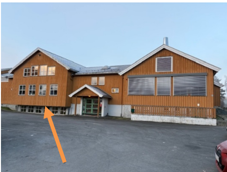
Mangler utvendig solavskjerming
