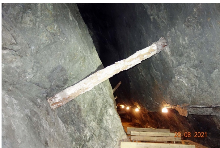
Foto B: Fra Konserthallen. Råtten props må fjernes og erstattes med kreosot-impregnerte stokker.
