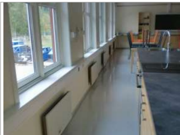
Bilde 91: Panelovner i bygget.
