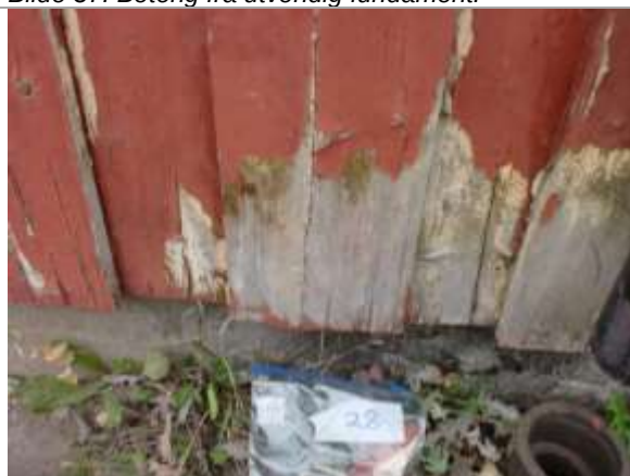
Bilde 39: Maling på utvendig kledning.
