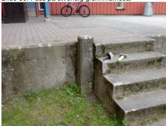
Bilde 52: Betong på utvendig fundament/trapp.
