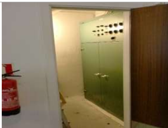
Bilde 92: Sikringsskap i bygget.
