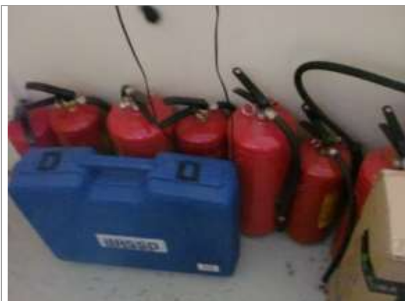
Bilde 73: Brannslukningsapparat observert.
