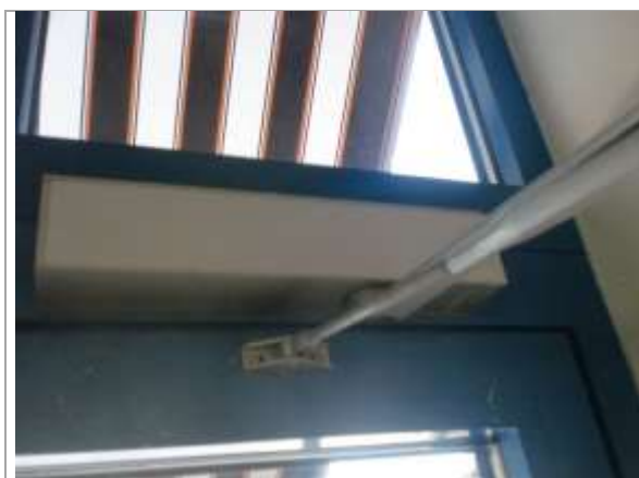
Bilde 65: Dørlukker pumpe i bygningen.
