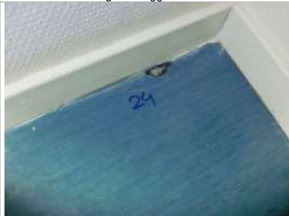
Bilde 15: Gulvbelegg på EI rom med påvist asbest.
