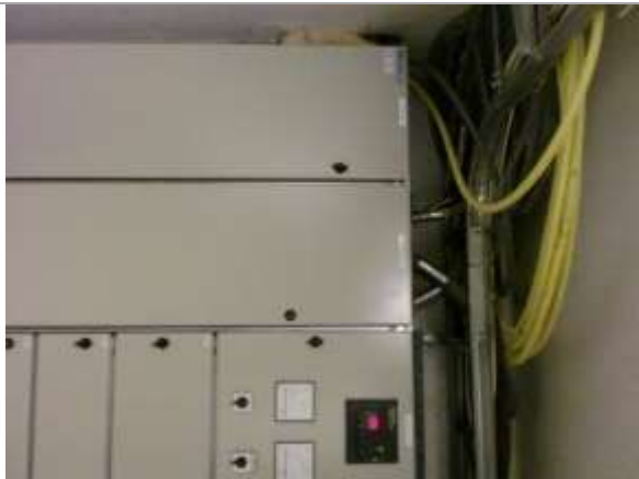
Bilde 86: Sikringsskap i bygget.
