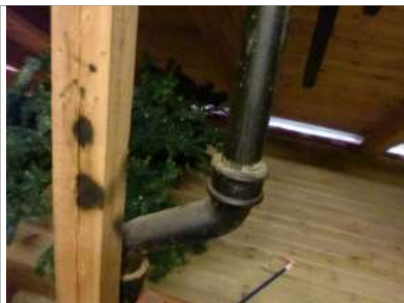
Bilde 53: Soilrør skjøt i bygget.
