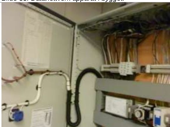
Bilde 90: Sikringsskap i bygget.
