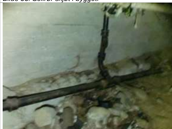
Bilde 55: Soilrør skjøt i bygget.
