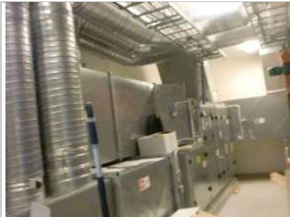
Bilde 75: Ventilasjonsanlegg i bygget.
