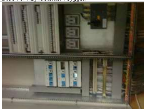
Bilde 81: Sikringsskap i bygget.
