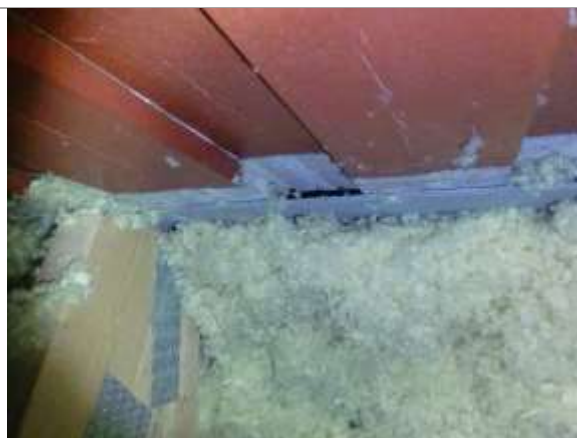
Bilde 6: Eternittplater i yttervegg.
