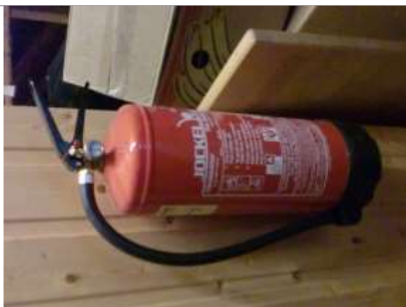
Bilde 74: Brannslukningsapparat observert.
