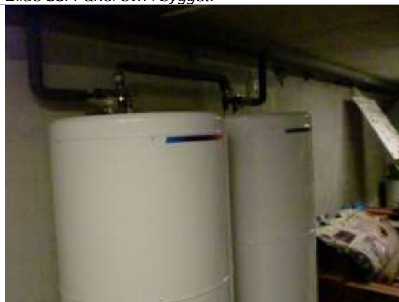
Bilde 87: Varmtvannsbereidere i bygget.
