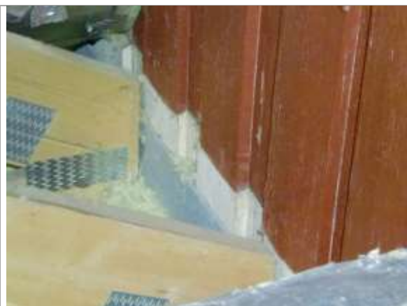
Bilde 5: Eternittplater i yttervegg.
