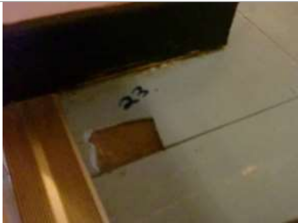
Bilde 14: Prøvetatt gulvbelegg med påvist asbest.
