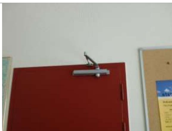
Bilde 66: Dørlukker pumpe i bygningen.
