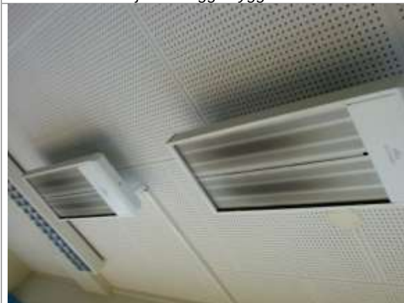
Bilde 77: Lysarmaturer og lysstoffrør i bygget.
