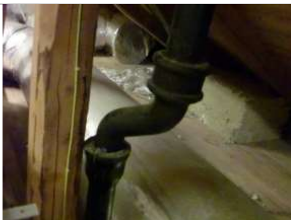
Bilde 54: Soilrør skjøt i bygget.
