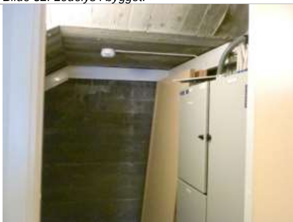
Bilde 84: Sikringsskap i bygget.
