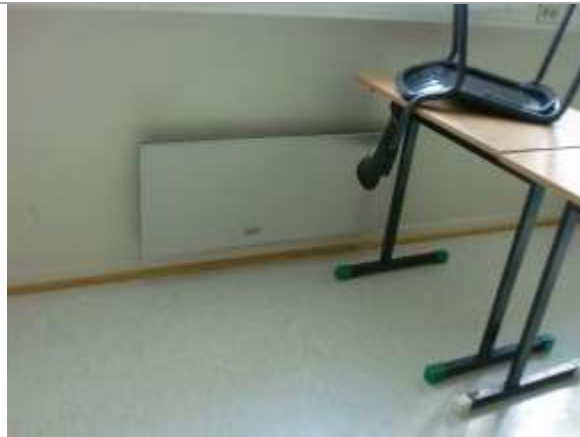
Bilde 85: Panel ovn i bygget.
