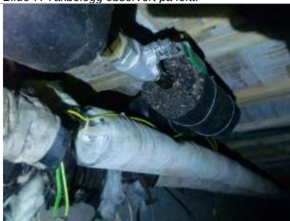
Bilde 9: Isolasjon i varmtvannsrør.
