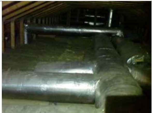
Bilde 76: Ventilasjonsanlegg i bygget.
