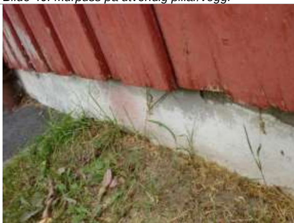
Bilde 42: Murpuss på utvendig grunnmur.
