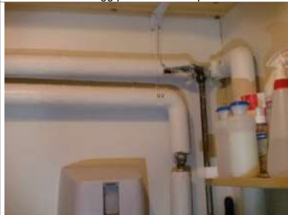
Bilde 17: Isolasjon i varmtvannsrør.
