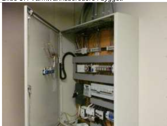
Bilde 89: Sikringsskap i bygget.
