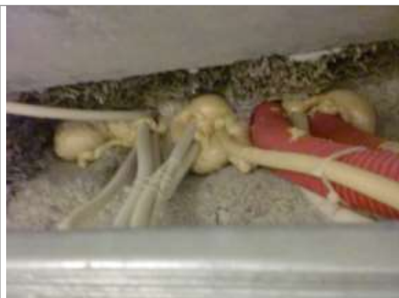
Bilde 71: PUR-skum/fugeskum observert rundt el kabel.
