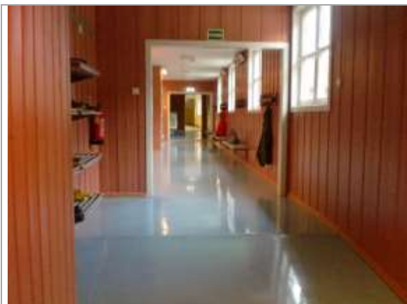
Bilde 59: Vinyl gulvbelegg i gangen.
