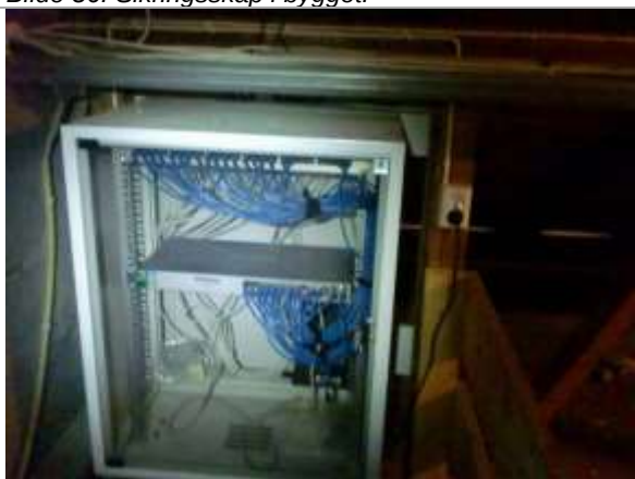
Bilde 88: Datanettverk apparat i bygget.
