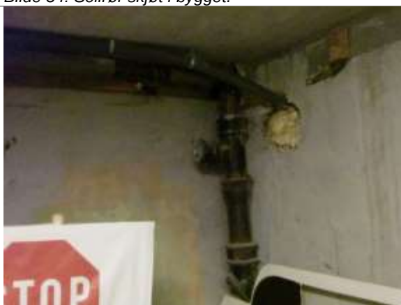
Bilde 56: Soilrør skjøt i bygget.
