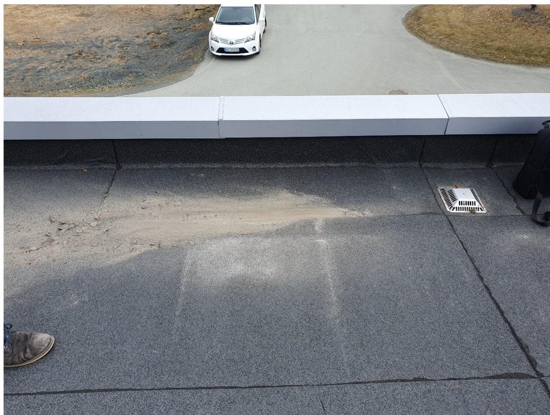
Bilde 6 – fukt i isolasjon i uk papptekking
