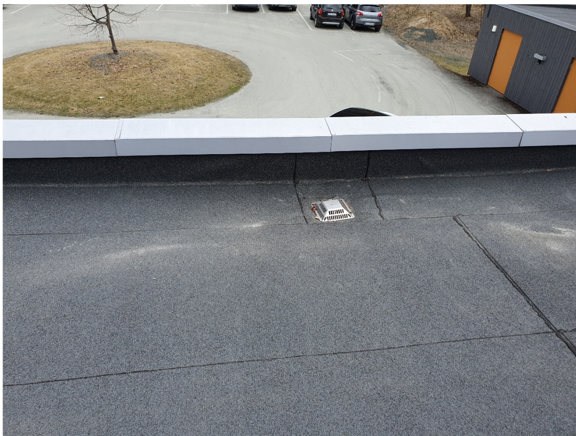
Bilde 1 – sluk tak over teknisk rom
