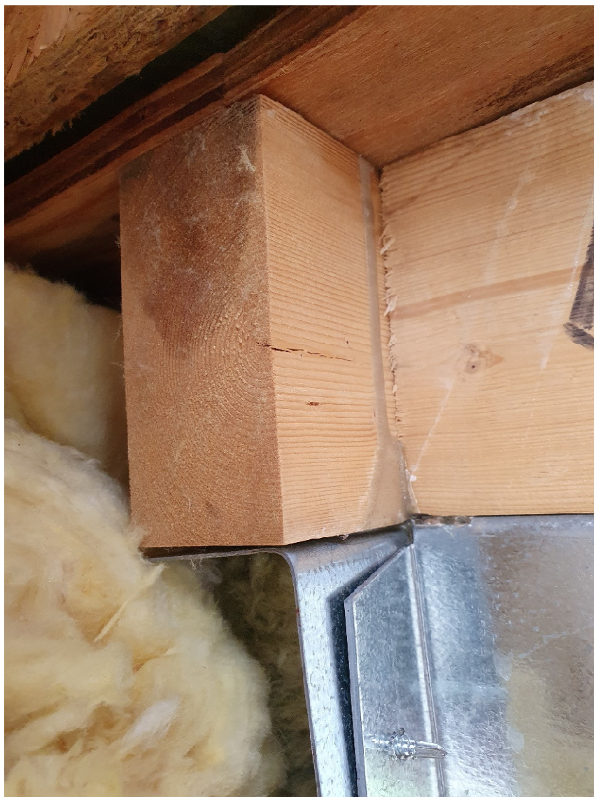
Bilde 5 - åpnet opp inn i takkonstruksjon, utvendig side ved teknisk rom – fukt i takfiner og takbjelke
