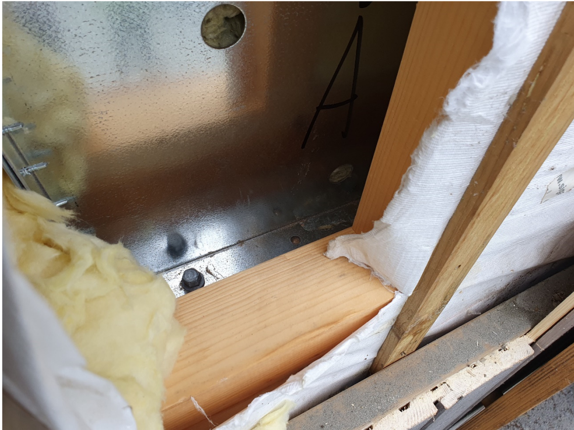
Bilde 4 – åpnet opp inn i takkonstruksjon, utvendig side ved teknisk rom – fukt i treverk og isolasjon. I tillegg er det fuktig i område mellom lettakelement og treverk.
