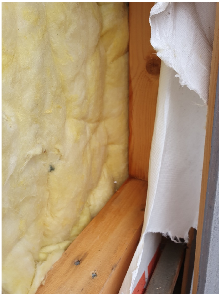
Bilde 7 - åpnet opp inn i takkonstruksjon, utvendig side ved kontor – fukt i treverk og isolasjon
