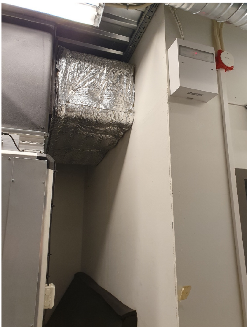
Bilde 2 – ventilasjonskanal i teknisk rom
