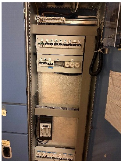
Sikringsskap med automatbrytere, det antas at det elektriske anlegget bør ha en kontroll.
