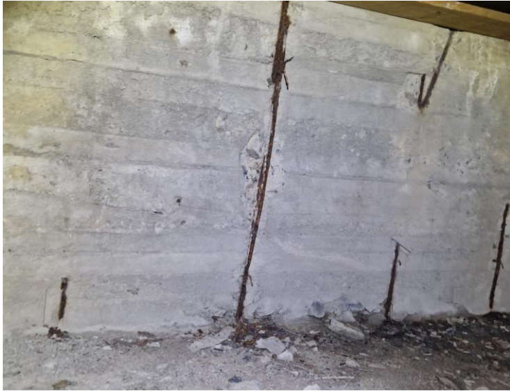
Krypkjeller. Rustspreng fra armeringsjern i grunnmur.
