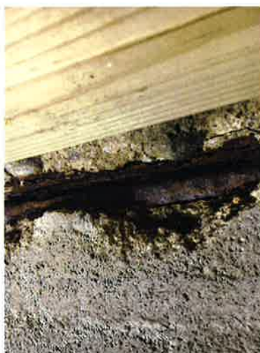
Overflenser med korrosjon
