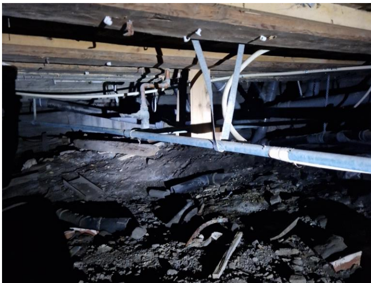
Krypkjeller med rør opplegg.
