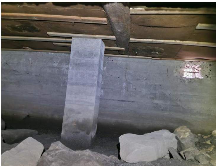
Krypkjeller. Tetting mot isolasjon i gulv med sutak plater beregnet for takteking. Bærer preg av fuktpåkjønning, og er porøse.
