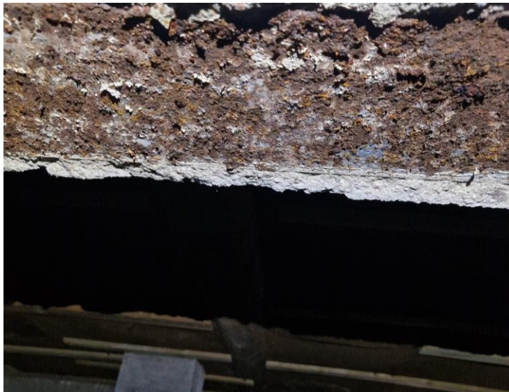
Krypkjeller. Rustspreng på ståldrager innstøpt i betong
