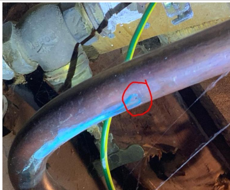
Hull i rør til varmtvannstank, lite hull i senter av rød ring.
