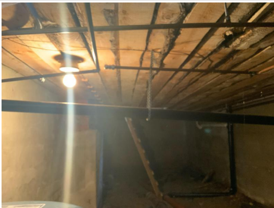
Åpent rørplegg under himling av grovskjærte bord.
