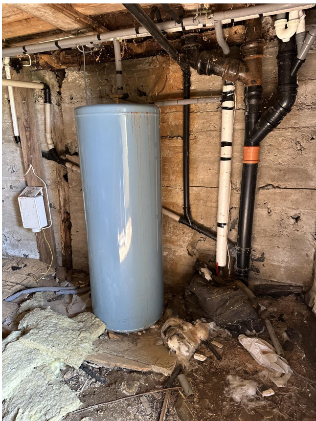
Varmtvannstank i kjeller.
