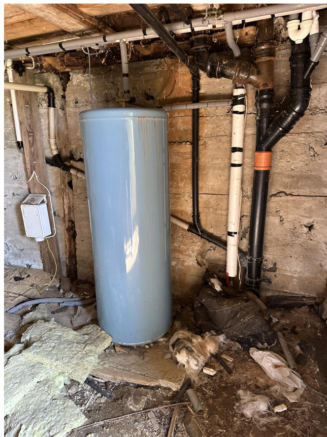
Varmtvannstank står kjellerrom
