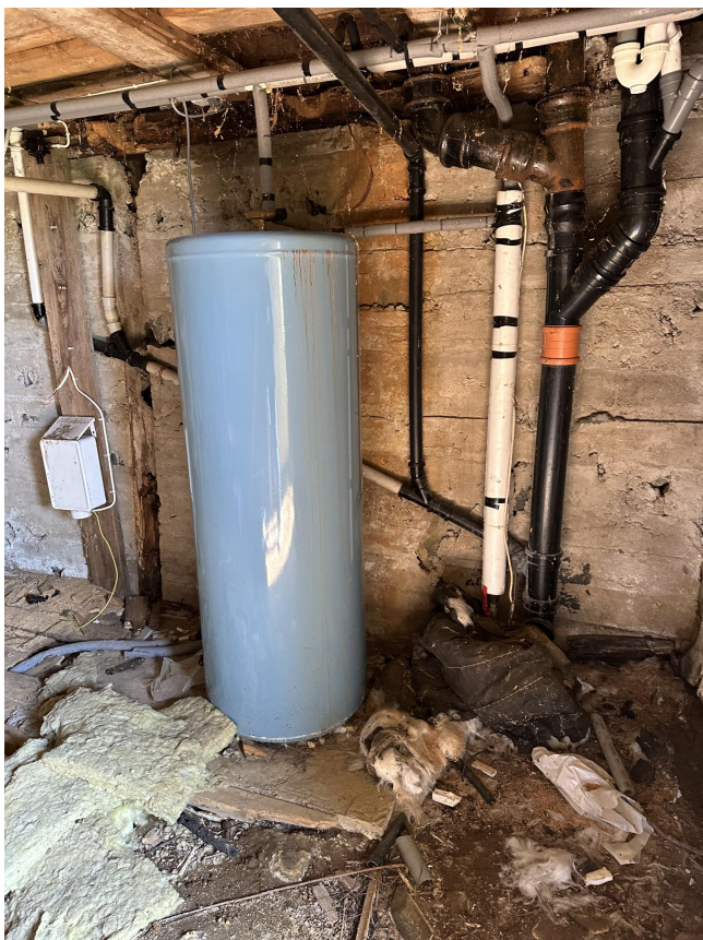
Varmtvannstank i kjeller.
